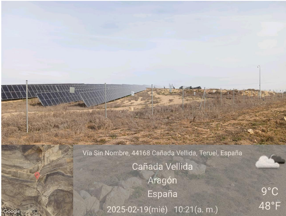
Ilustración 4. Acumulación de maleza sobre el vallado.
