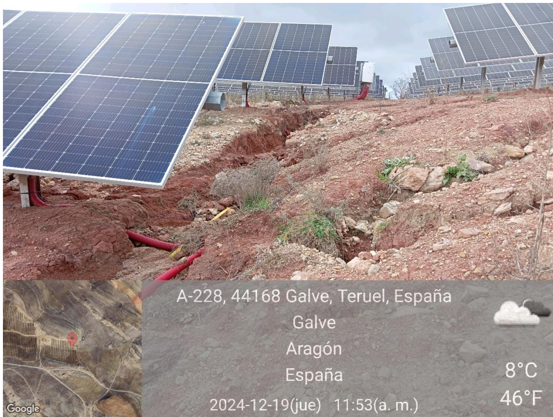
Ilustración 5. Erosión muy grave entre paneles al sur de la poligonal 1.
