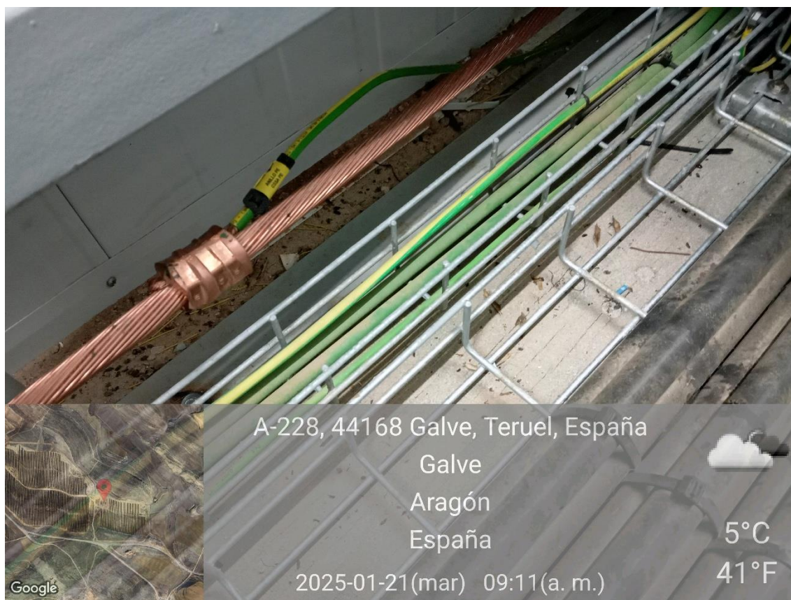
Ilustración 9. Excrementos de roedor en el centro transformador de la poligonal 2.
