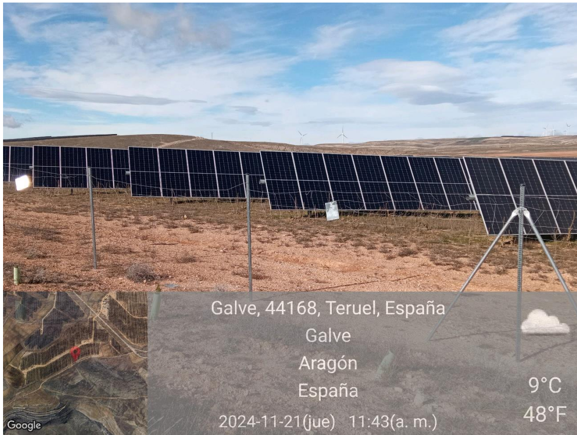
Ilustración 4. Vallado roto al noreste de la poligonal 3.
