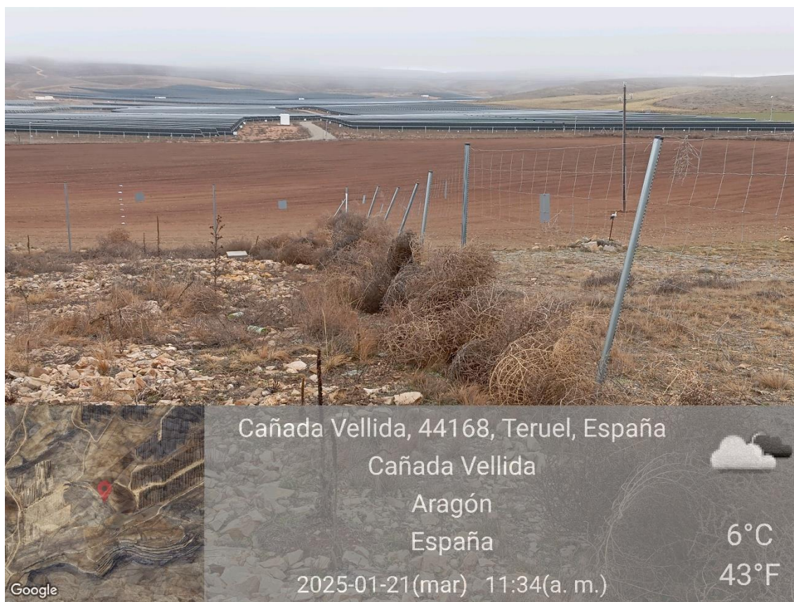
Ilustración 8. Vegetación acumulada al noreste de la poligonal cuatro comprometiendo su estructura y funcionalidad.
