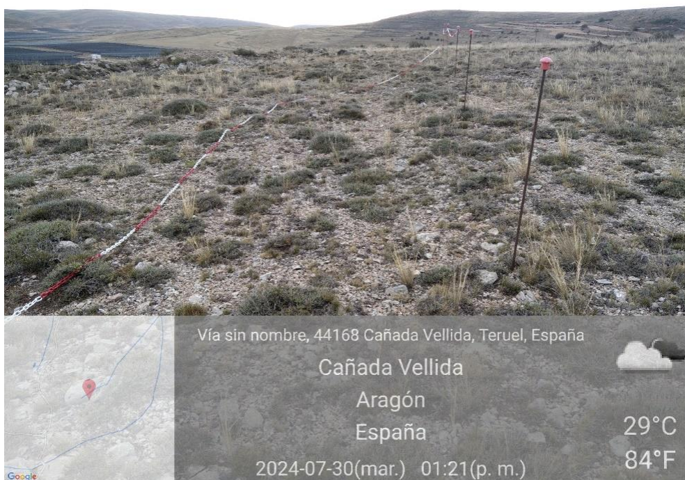
Ilustración 8. Trinchera mal acordonada
