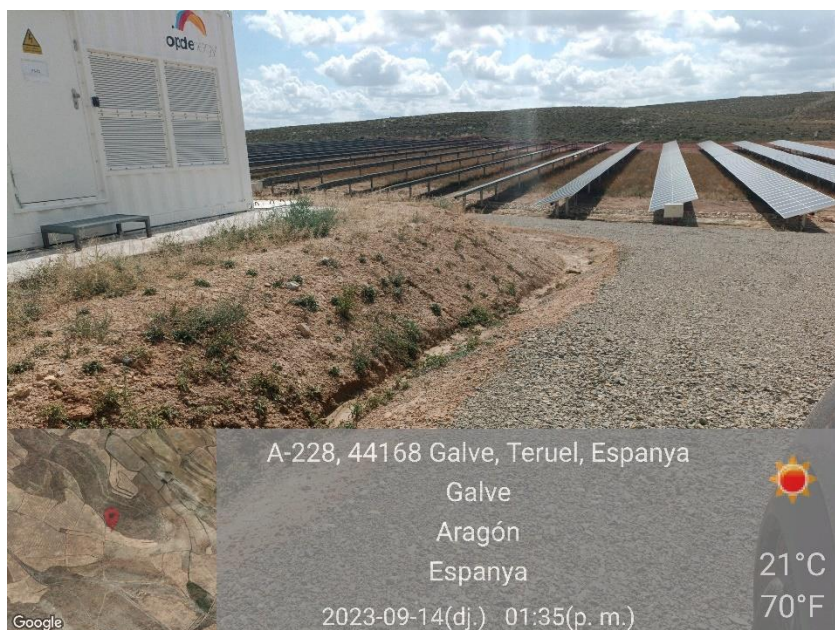
Ilustración 2.. Acúmulo de sedimentos en canaletas del CT en zona1.
