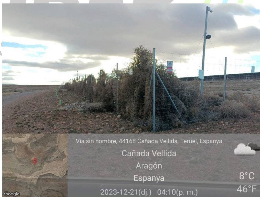
Ilustración 7. Vegetación acumulada en el vallado de la zona 4.
