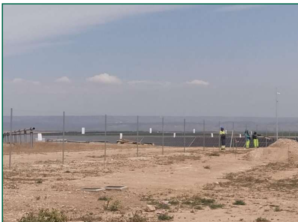
Fotografía 12. Vallado con placas anticollisión.
