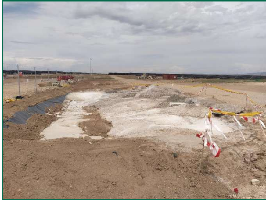
Fotografía 26. Zona de lavado de hormigón llena.
