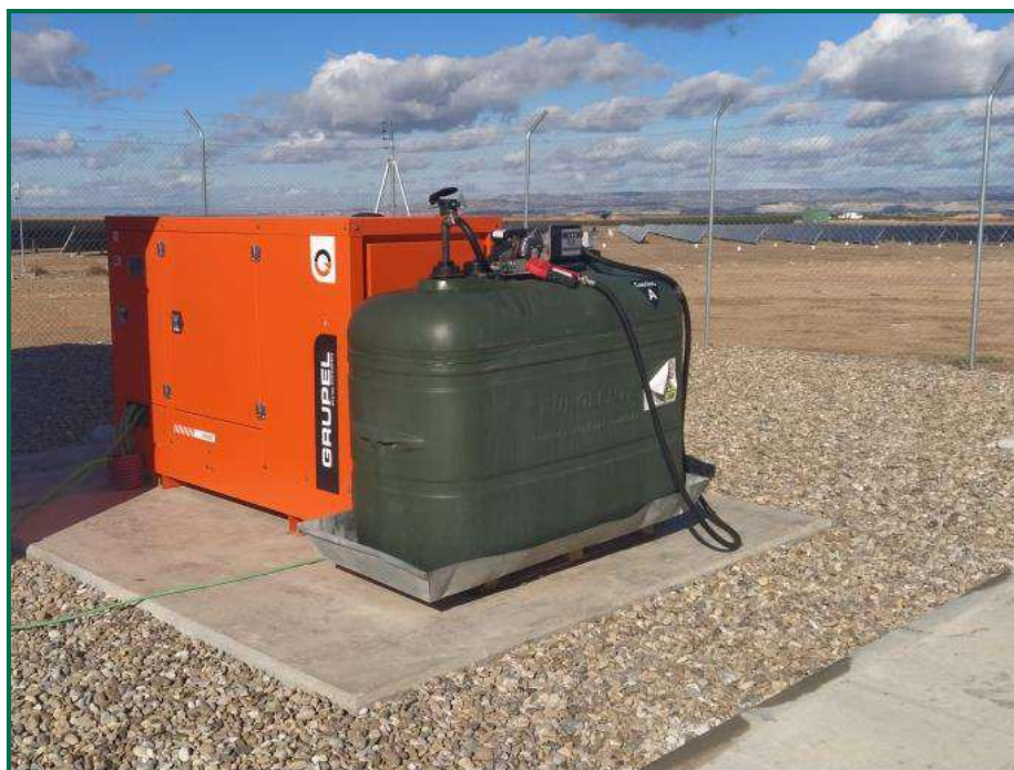
Fotografía 31. Grupo electrógeno en la SET.
