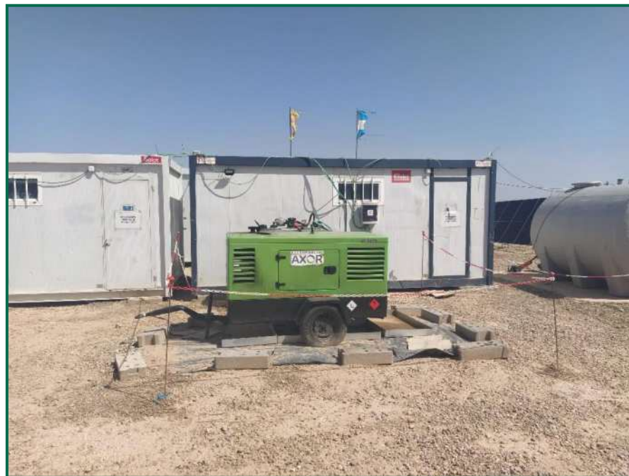
Fotografía 30. Grupo electrógeno de la zona de casetas de obra, ya retirado.
