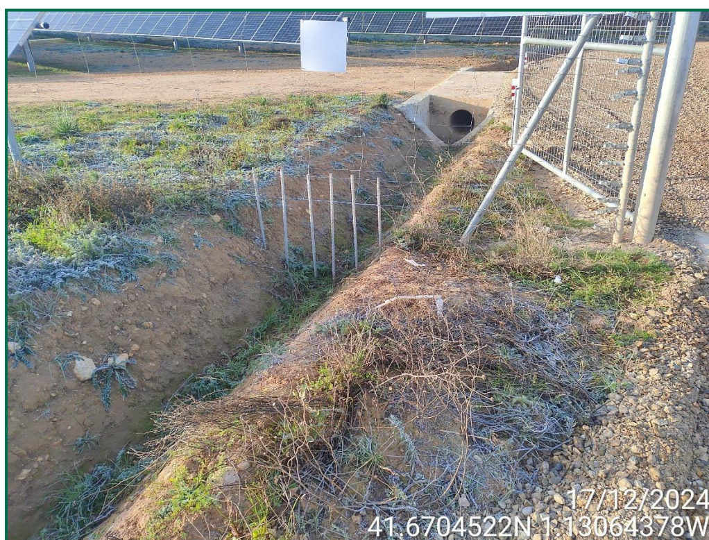
Fotografía 1. Drenaje de la planta solar.
