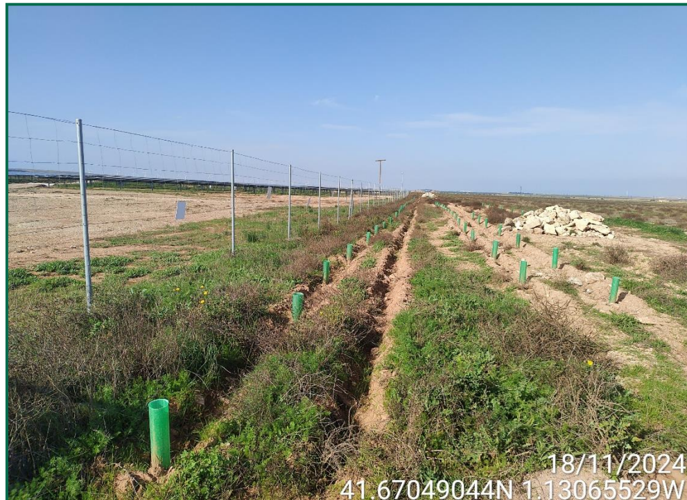
Fotografía. Vallado perimetral con placas anticollisión.
