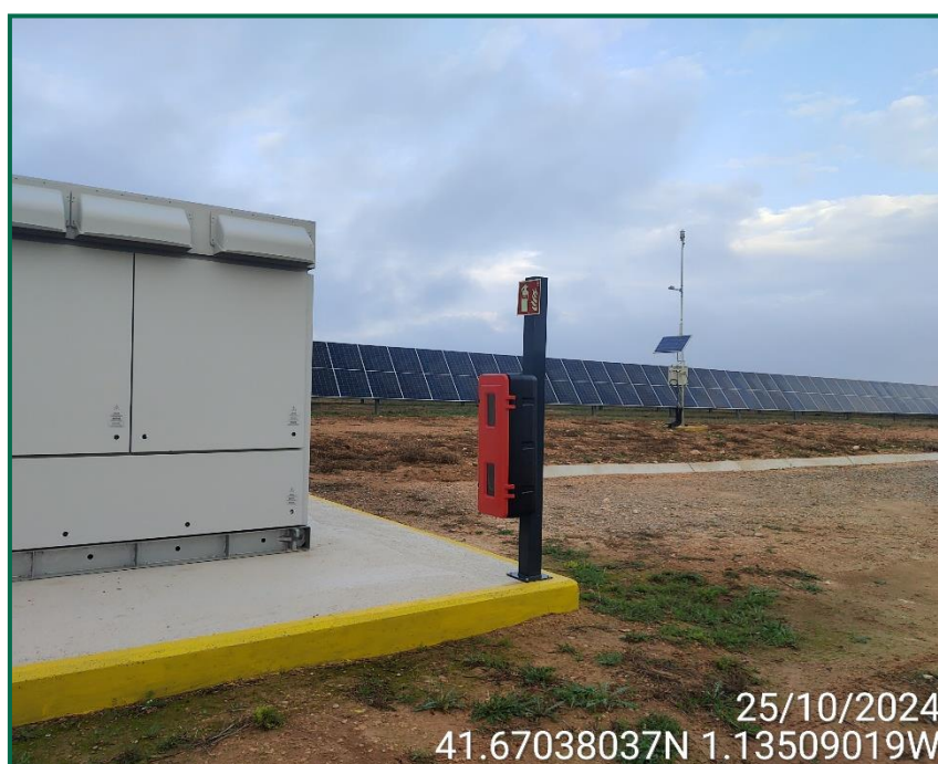
Fotografía 11. Extintor junto a inversor.
