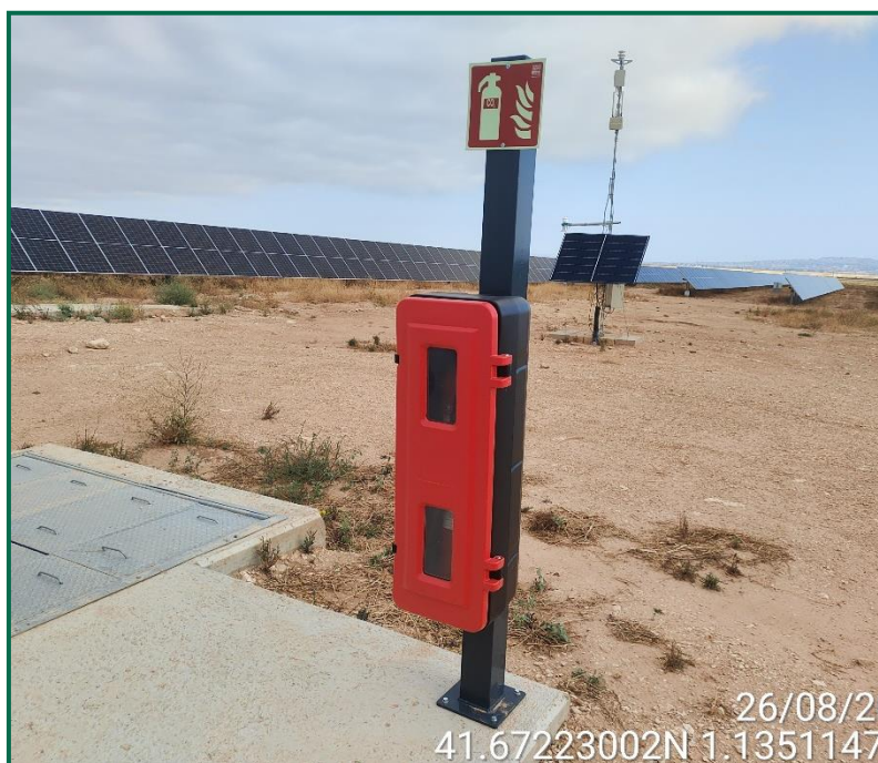
Fotografía 11. Extintor junto a inversor.
