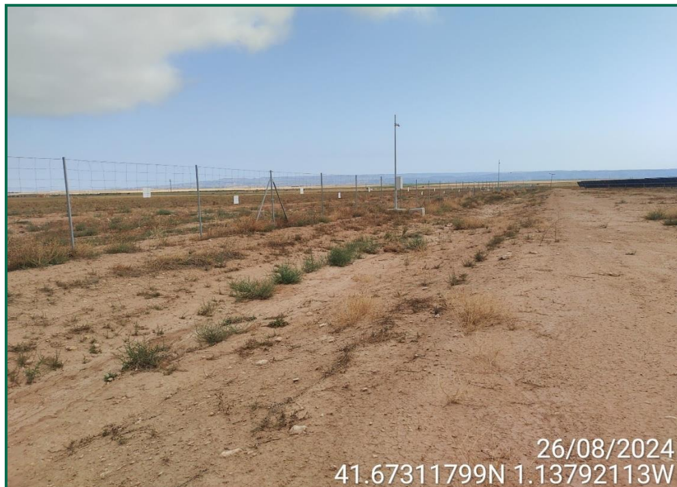
Fotografía. Vallado perimetral con placas anticollisión.
