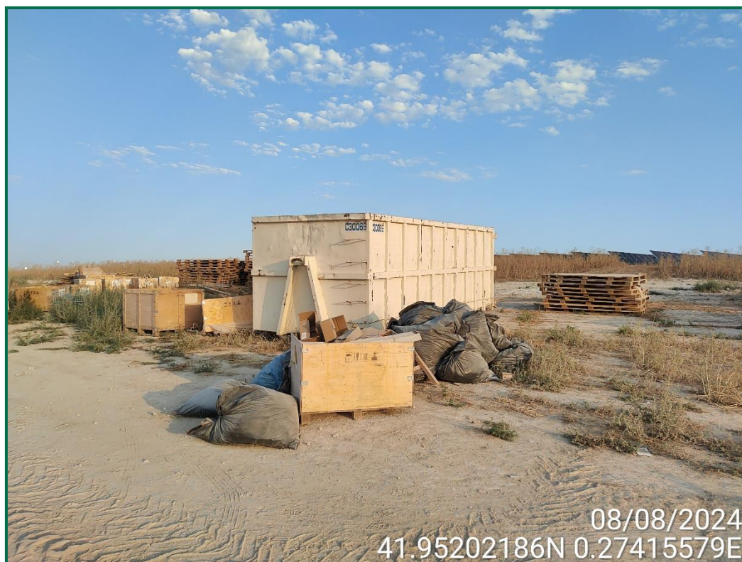
Fotografía 8. Conenedores para residuos inertes.
