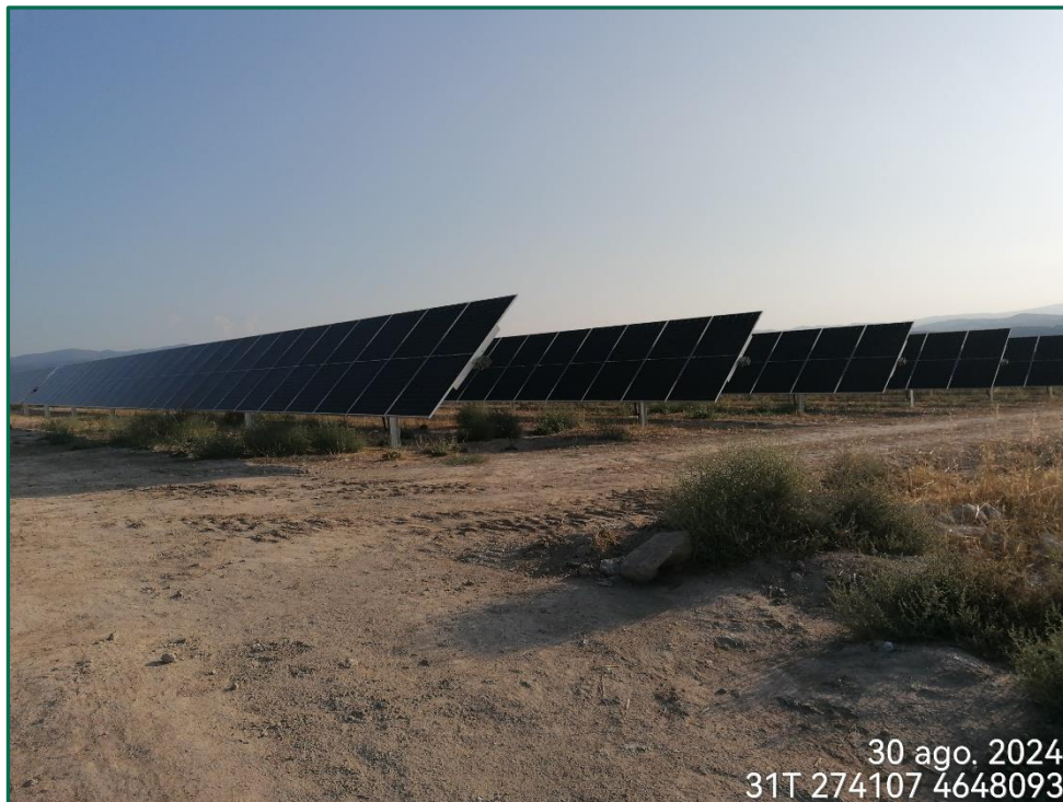
Fotografía 1. Placas solares ya colocadas.
