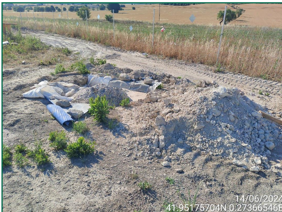
Fotografía 12. Balsa de lavado de hormigón.
