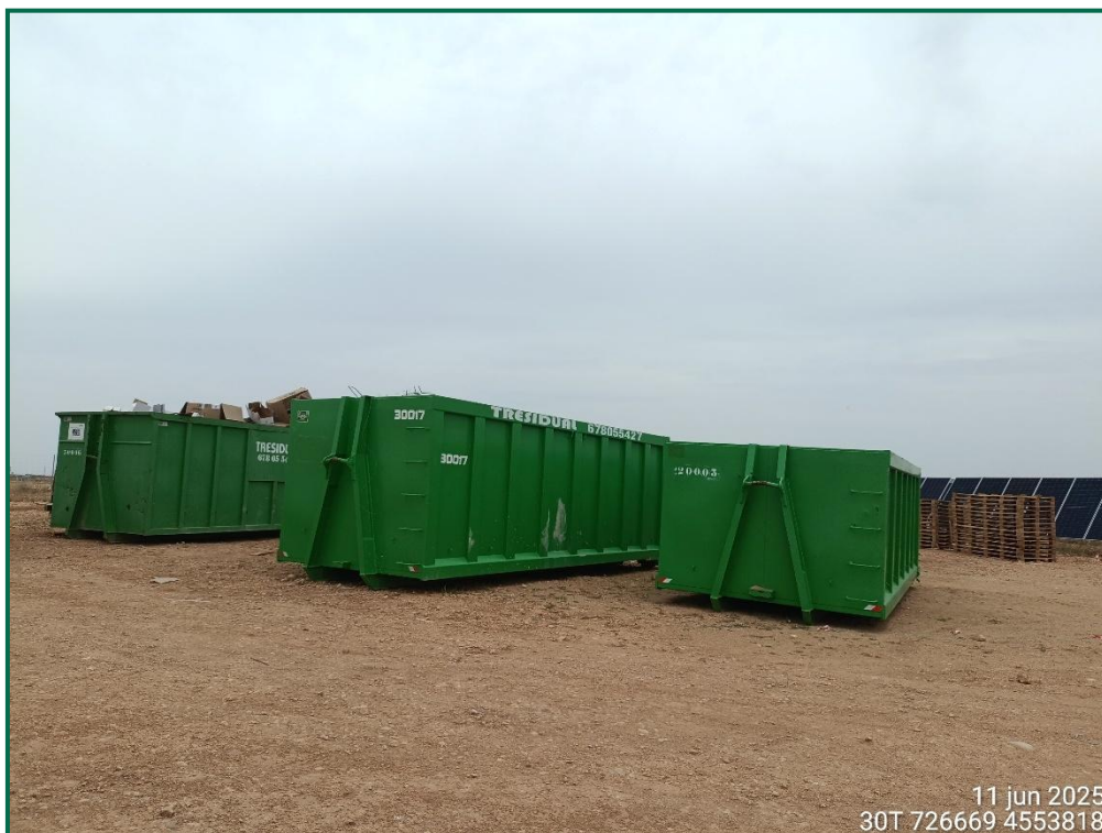
Fotografía 9. Punto limpio de residuos inertes.
