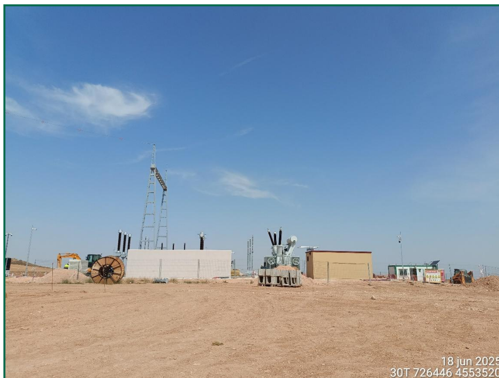
Fotografía 3. Vallado provisional SET LA ESTANCA.
