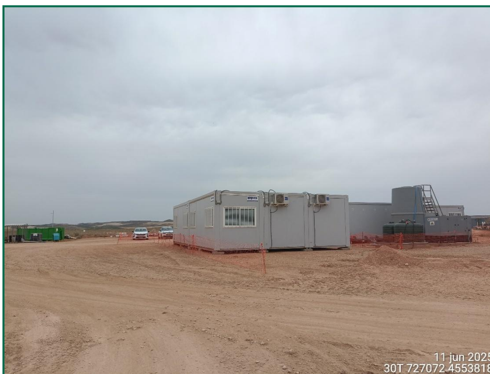
Fotografía 8. Oficinas, grupo electrógeno y bidones de combustible.
