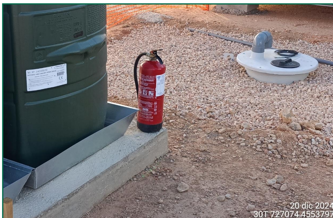
Fotografía 21. Extintor junto a bidones de combustible.
