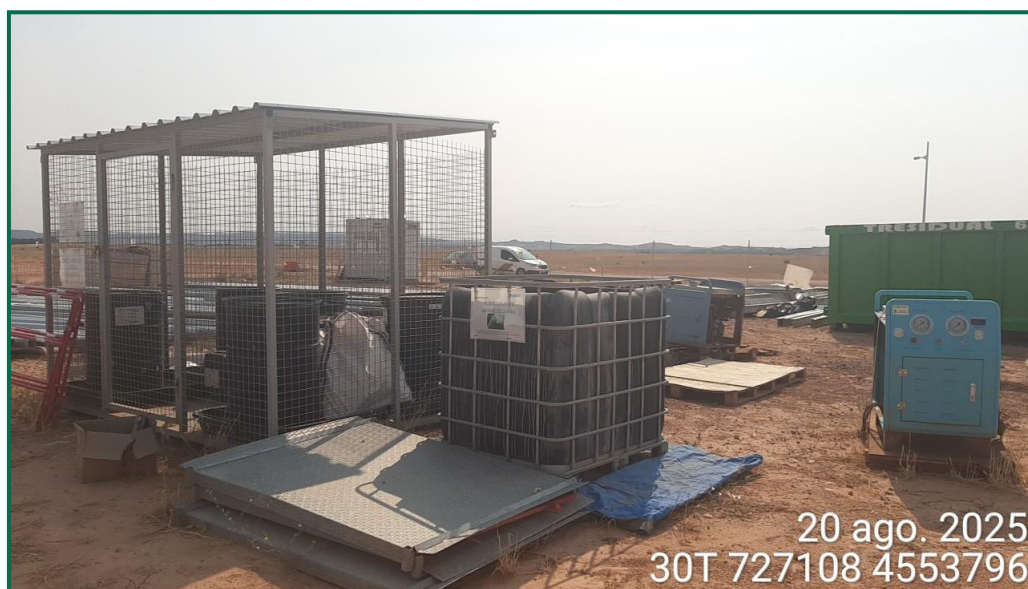
Fotografía 10. Punto limpio para residuos peligrosos.
