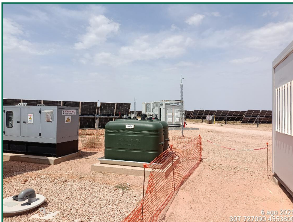
Fotografía 8. Oficinas, grupo electrógeno y bidones de combustible.
