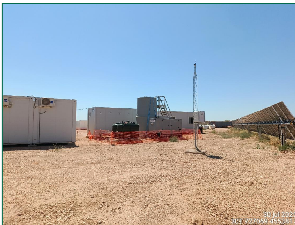
Fotografía 10. Oficinas, grupo electrógeno y bidones de combustible.
