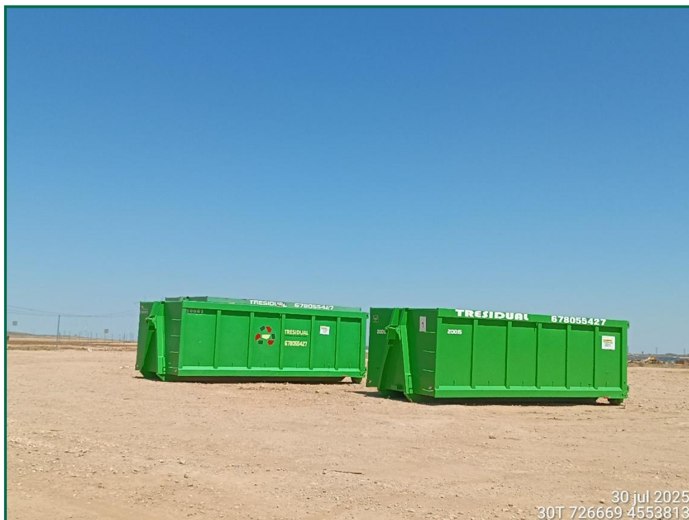
Fotografía 11. Punto limpio de residuos inertes.
