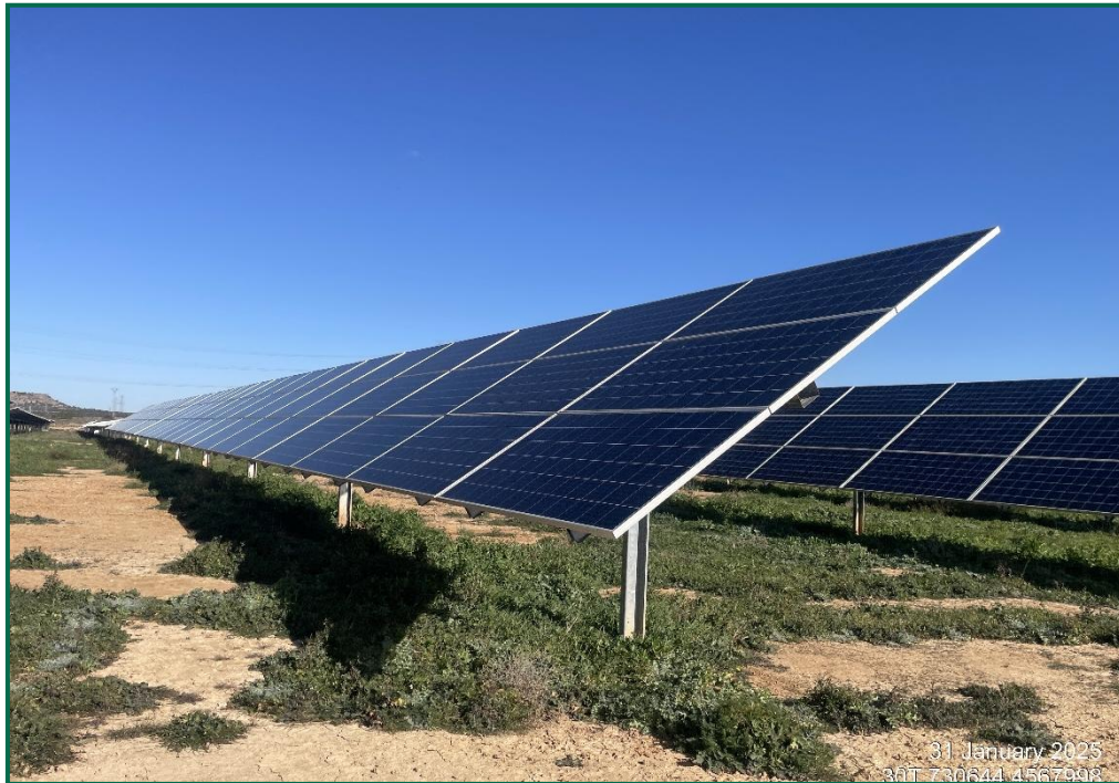
Fotografía 1. Vegetación entre placas actualmente.
