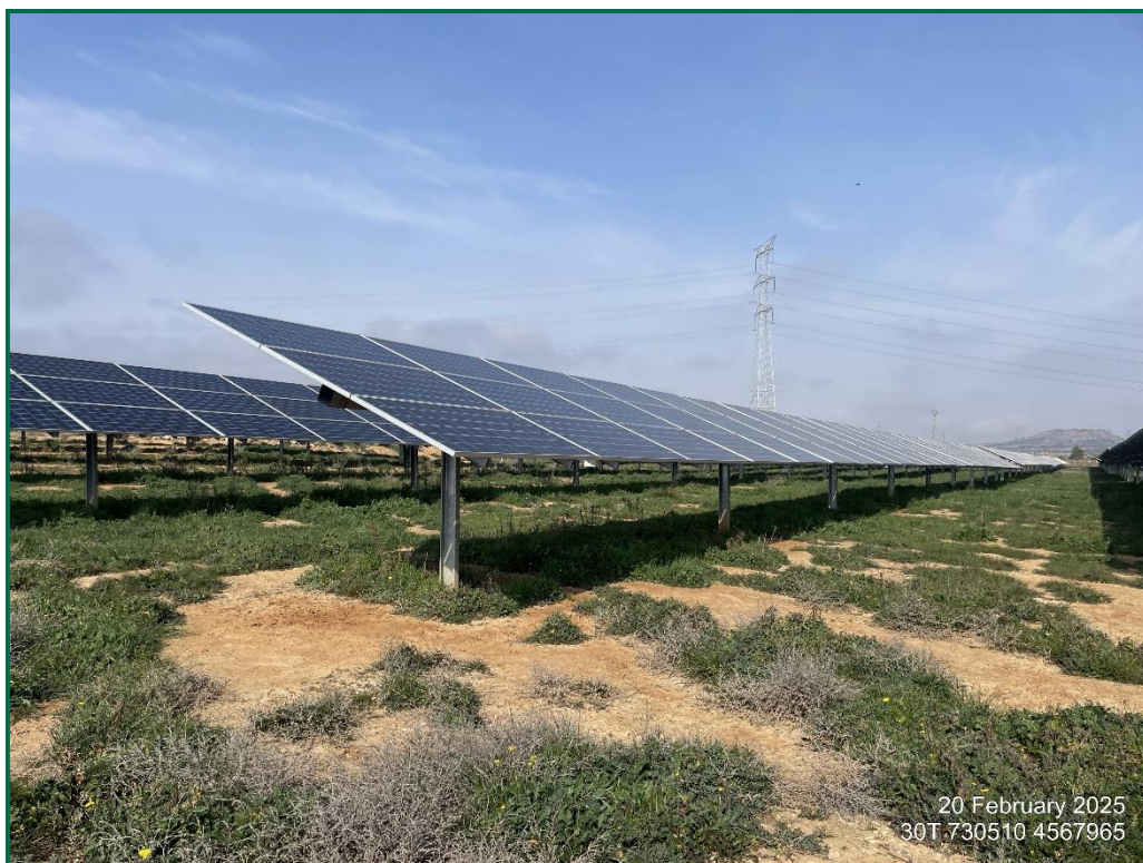
Fotografía 2. Vegetación entre placas actualmente.
