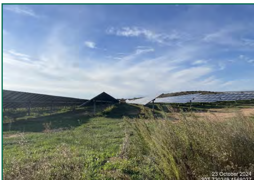
Fotografía 1. Vegetación entre placas actualmente.
