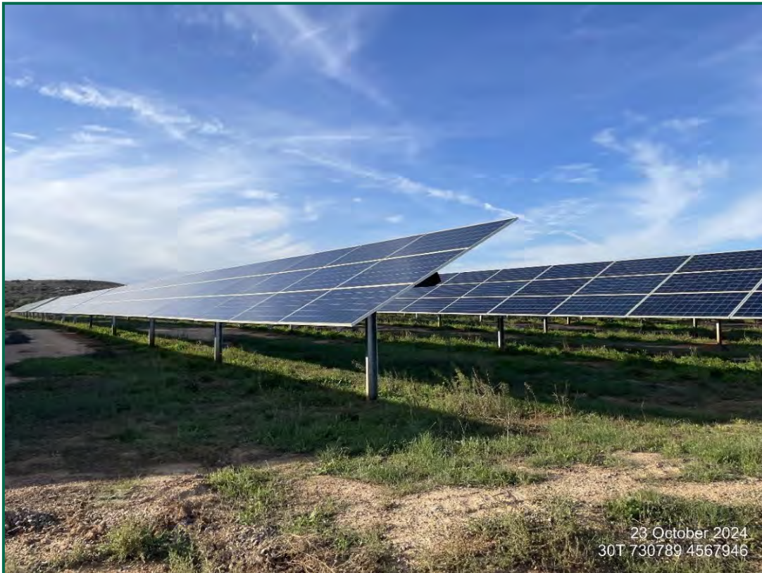
Fotografía 2. Vegetación entre placas actualmente.
