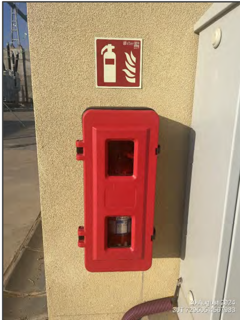
Fotografía 34. Extintores en edificio de control.
