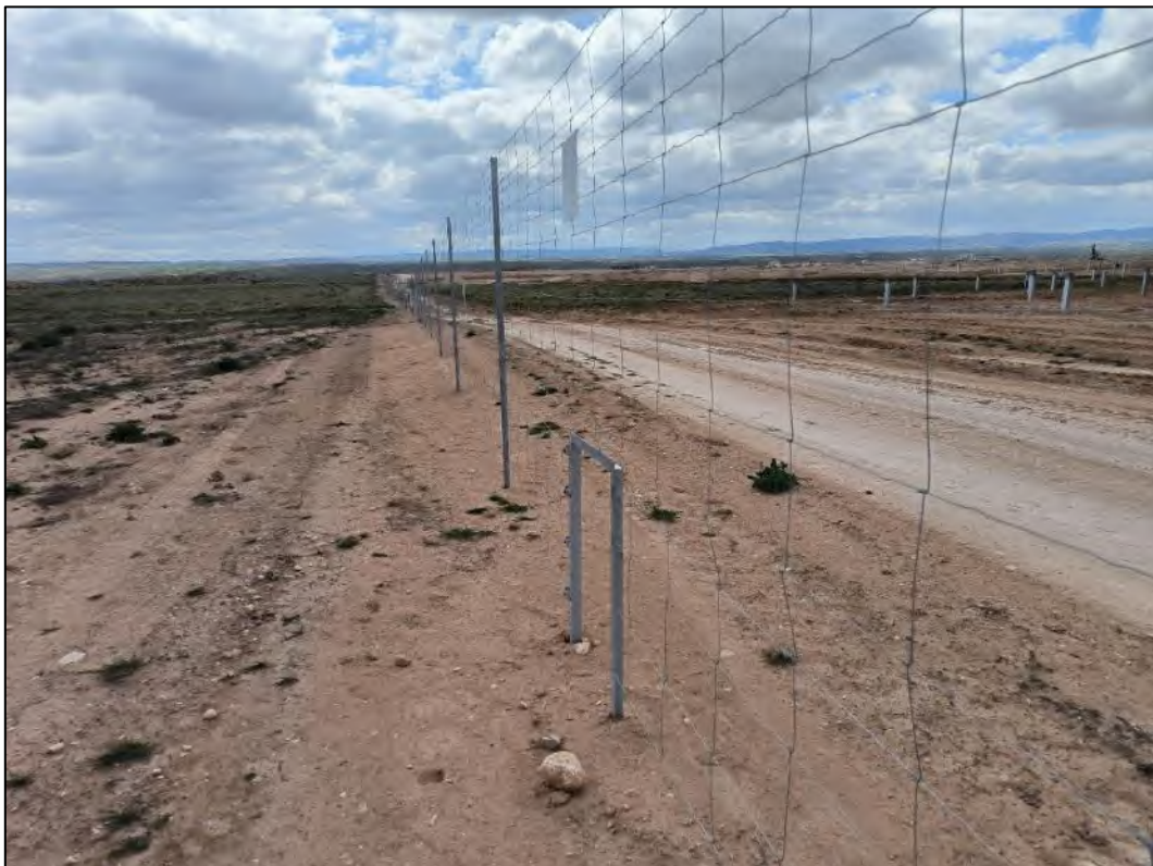
Figura nº 84. Paso de fauna instaladas en el vallado de acuerdo a DIA.
