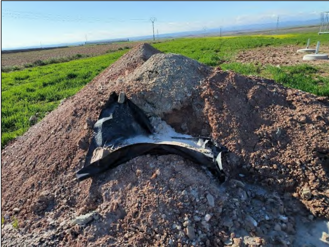
Figura nº 79. Fosa impermeabilizada de lavado de hormigón. Apoyo T32
