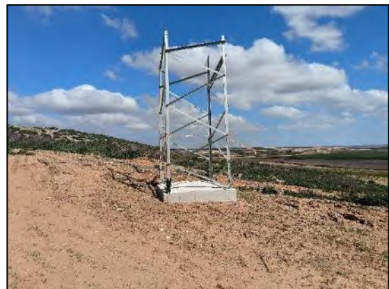
Figura nº 47. Situación Apoyo T10
