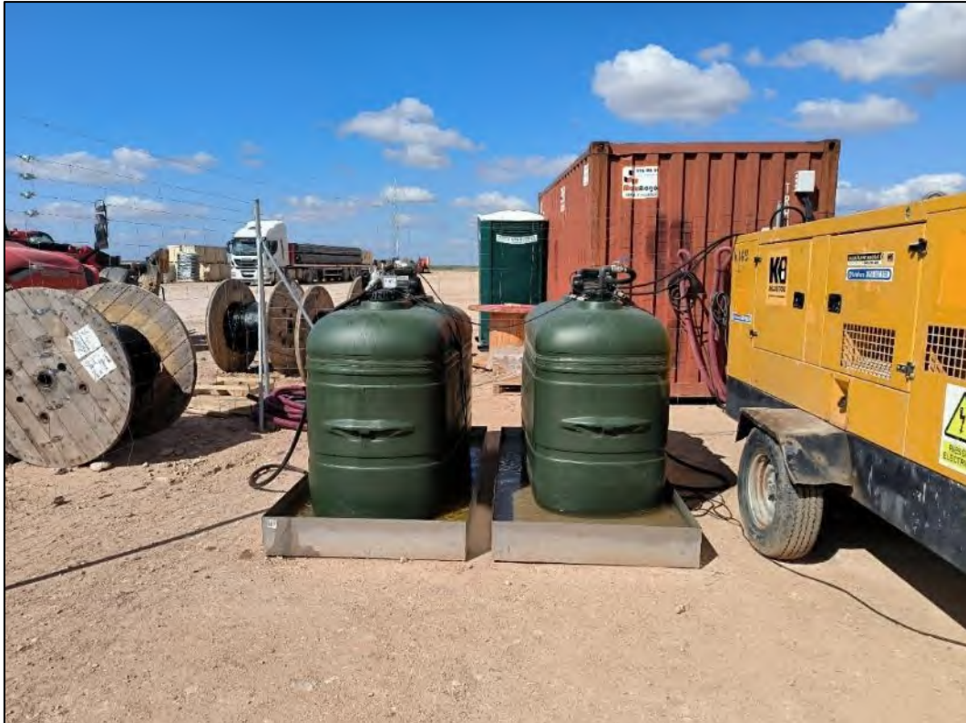
Figura nº 72. Control de vertidos accidentales de depósitos de combustible del grupo electrógeno mediante cubetas de retención
