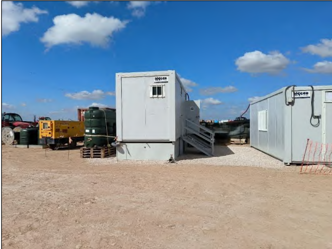
Figura nº 14. Servicios sanitarios en zona de oficinas.
