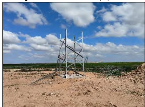
Figura nº 53. Situación Apoyo T04
