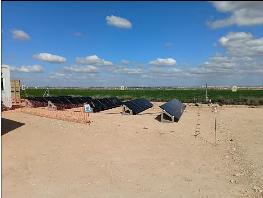
Figura nº 12. Paneles fotovoltaicos para autoconsumo en zona de oficinas.
