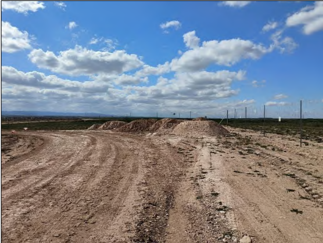
Figura nº 81. Acopio de tierra vegetal junto SET de transformación.
