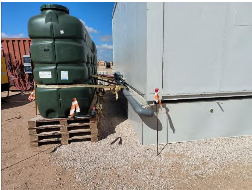
Figura nº 73. Depósitos de aguas residuales servicios sanitarios. Zona de oficinas.
