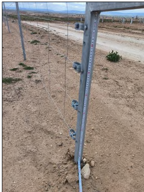
Figura nº 86. Detalle de paso de fauna de 50 cm de ancho por 79 cm de alto en el vallado.
