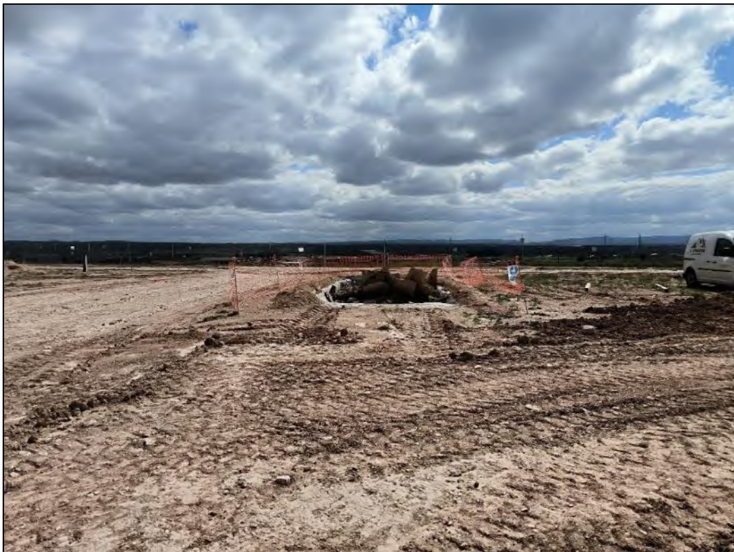
Figura nº 74. Fosa impermeabilizada de lavado de hormigón. Zona de acceso a planta.
