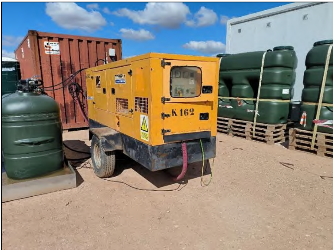
Figura nº 15. Acopio principal: Grupo electrógeno y depósito de combustible sobre cubeta de retención.
