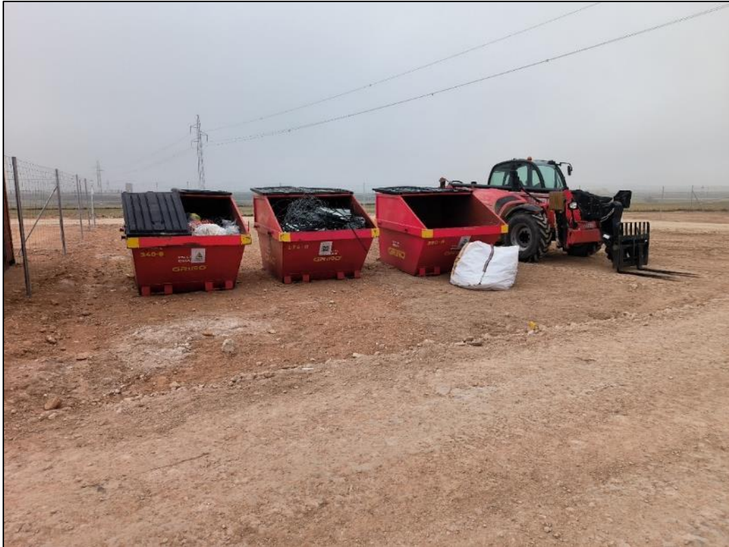
Figura nº 51. Localización de contenedor para residuos no peligrosos en acopio principal.
