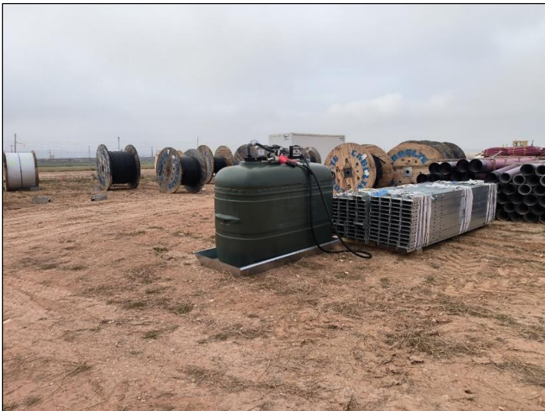
Figura nº 14. Depósito de combustible sobre cubeta de retención en zona de planta.
