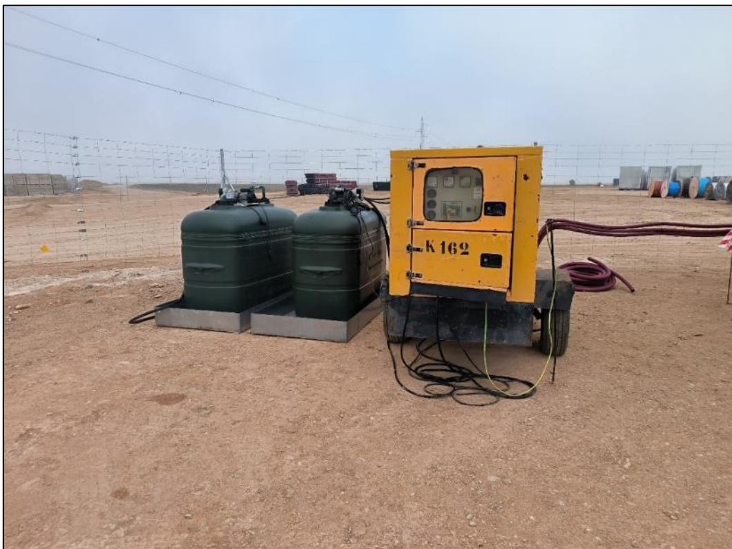
Figura nº 10. Acopio principal: Grupo electrógeno y depósito de combustible sobre cubeta de retención.
