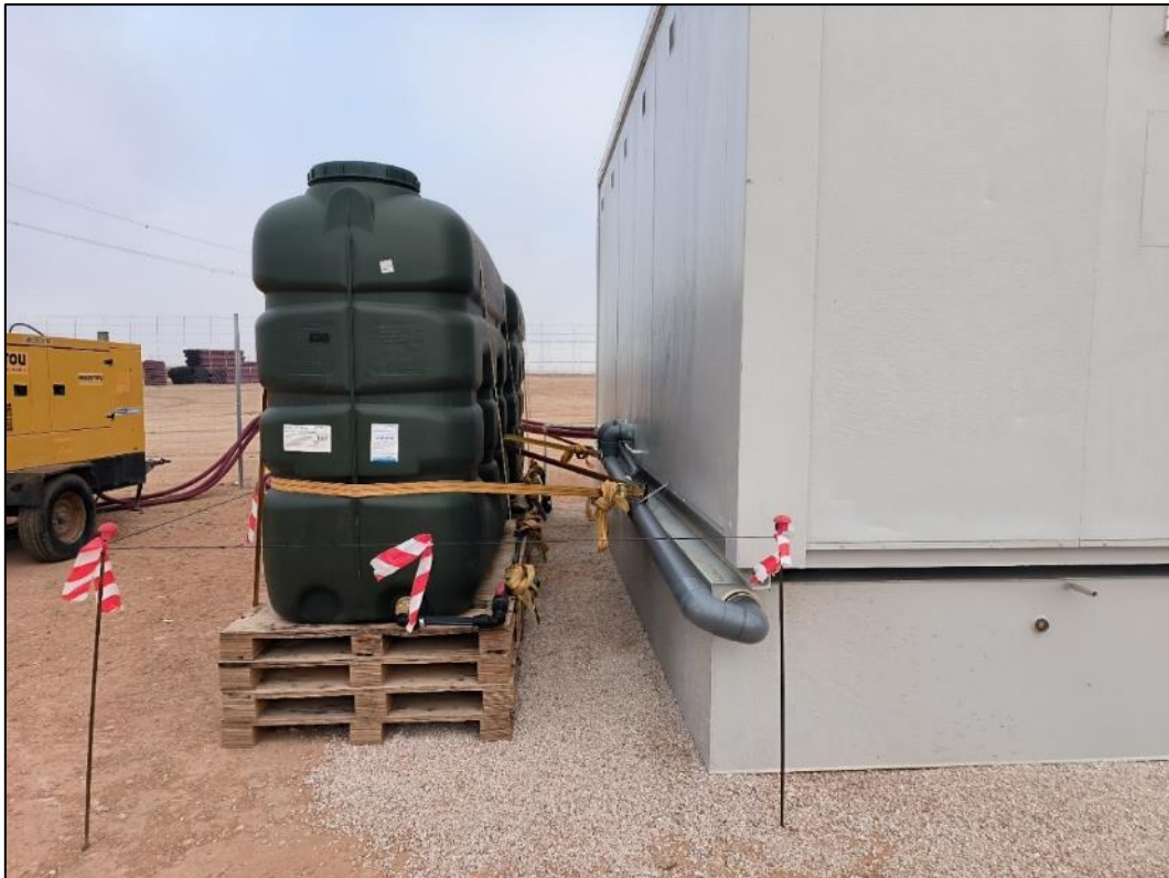
Figura nº 9. Depósitos de los servicios sanitarios en zona de oficinas.
