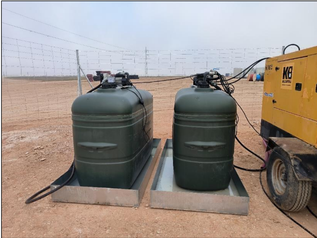
Figura nº 48. Control de vertidos accidentales de depósitos de combustible mediante cubetas de retención
