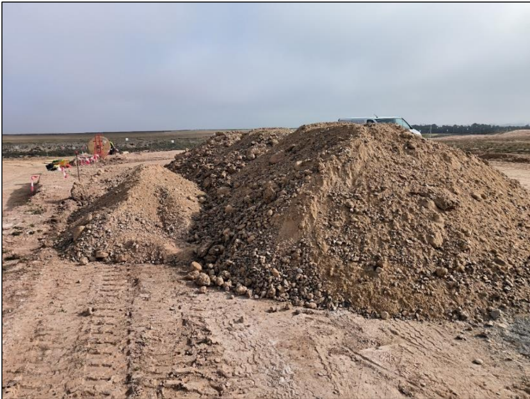
Figura nº 55. Acopio de tierra vegetal junto SET de transformación.
