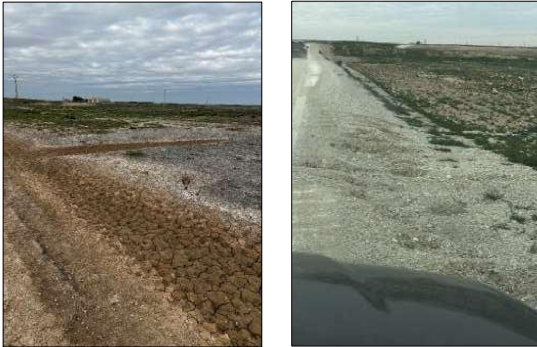
Figura nº 4. Ejemplo de cunetas que precisan corrección.
