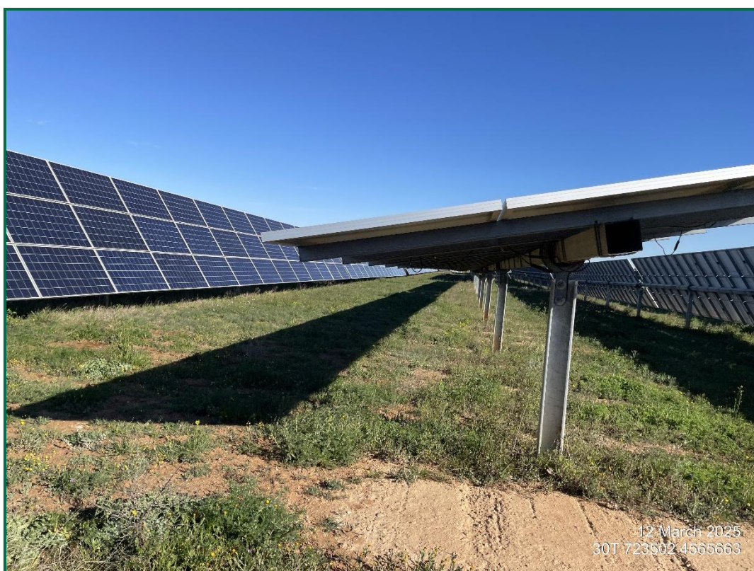
Fotografía 1. Vegetación entre placas en su estado actual.
