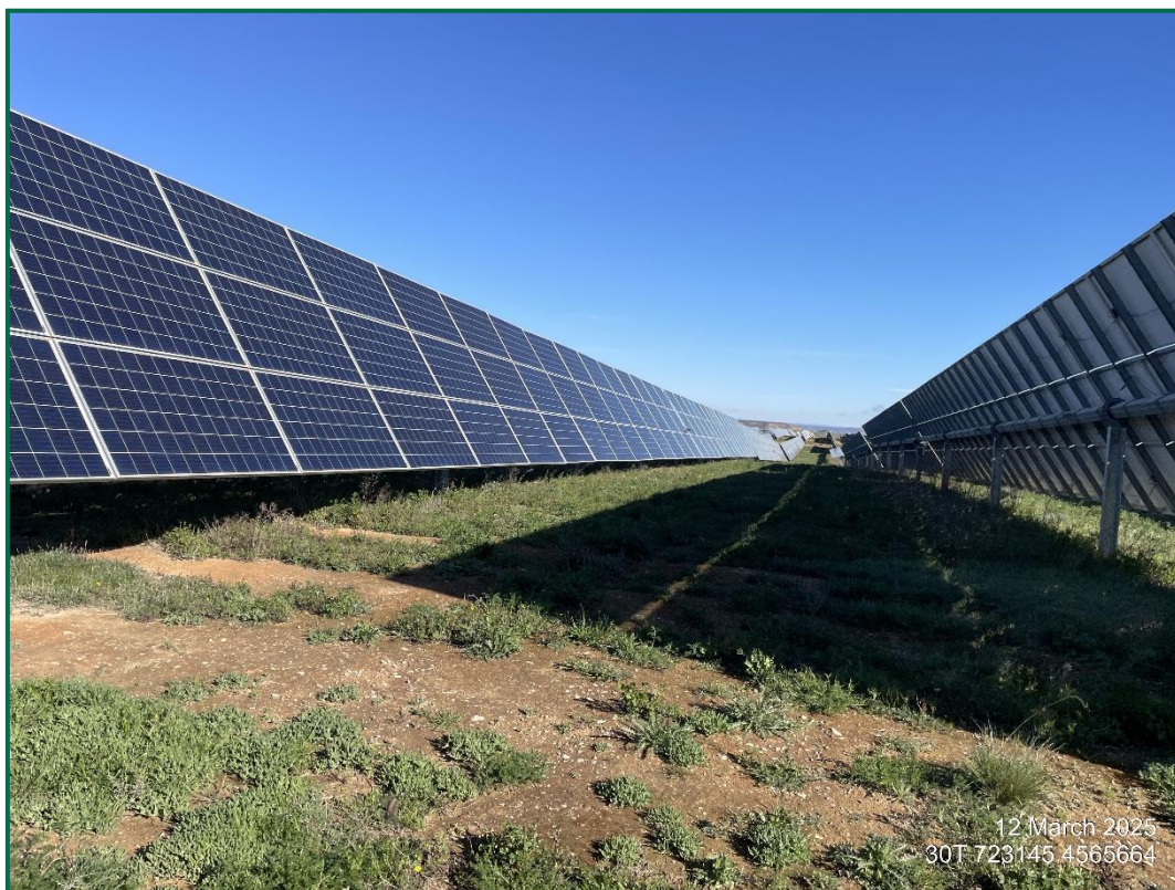
Fotografía 2. Vegetación entre placas en su estado actual.
