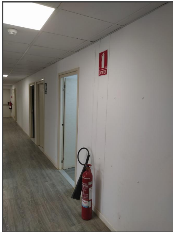
Fotografía 24. Extintores en edificio de control.
