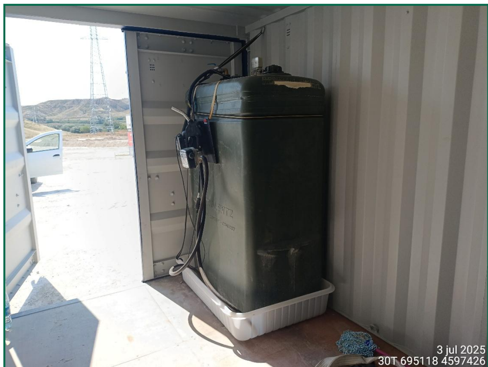
Fotografía 19. Depósito para combustible.
