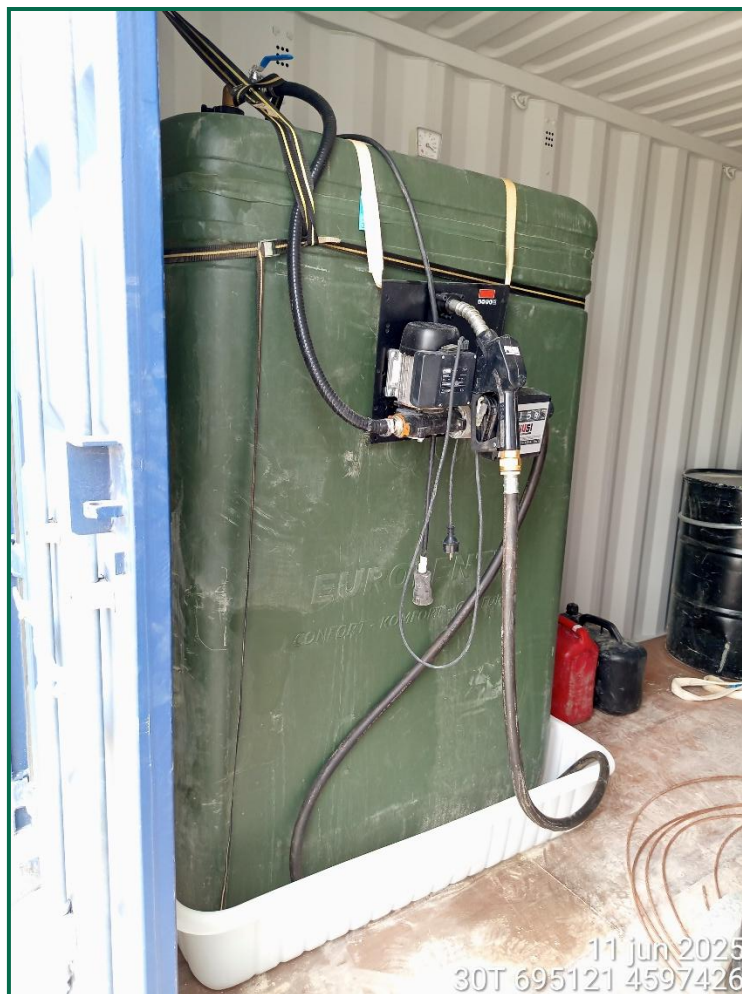
Fotografía 18. Depósito para combustible.
