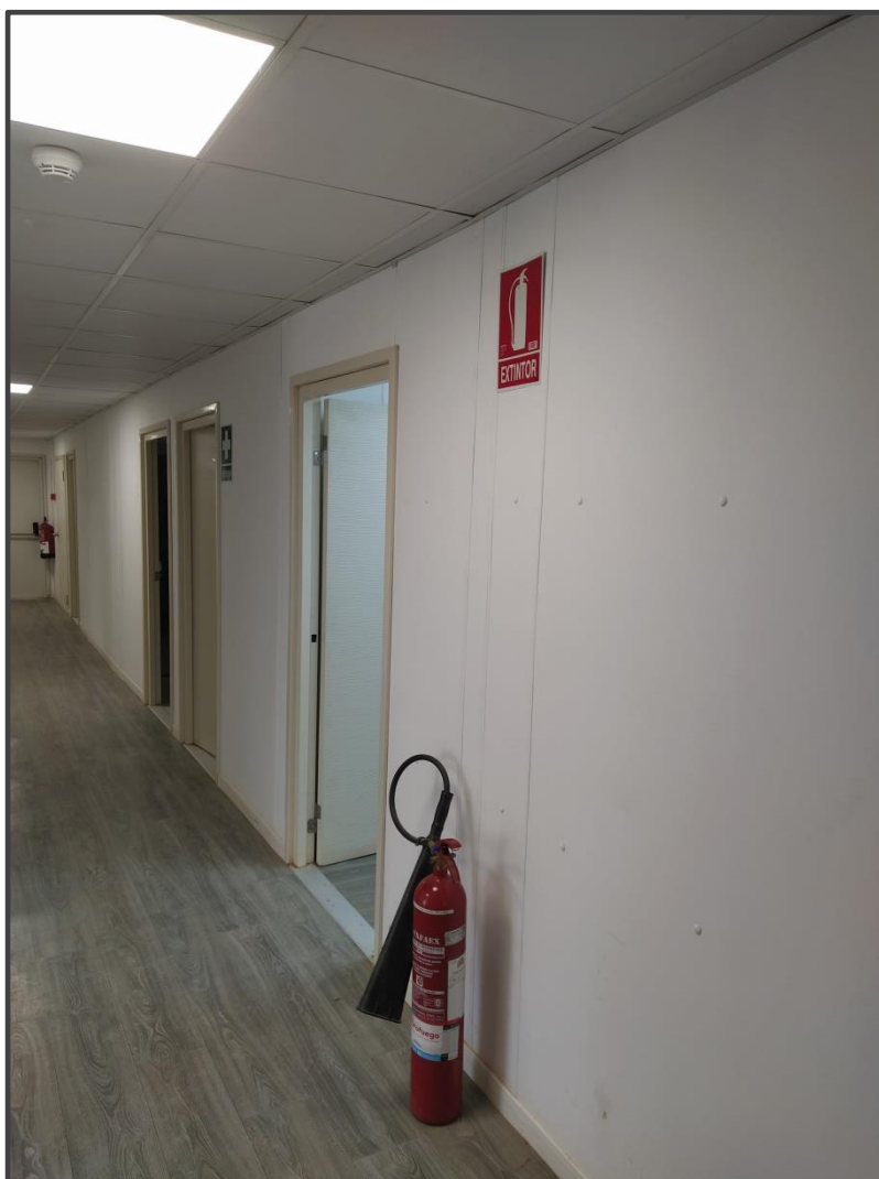
Fotografía 22. Extintores en edificio de control.
