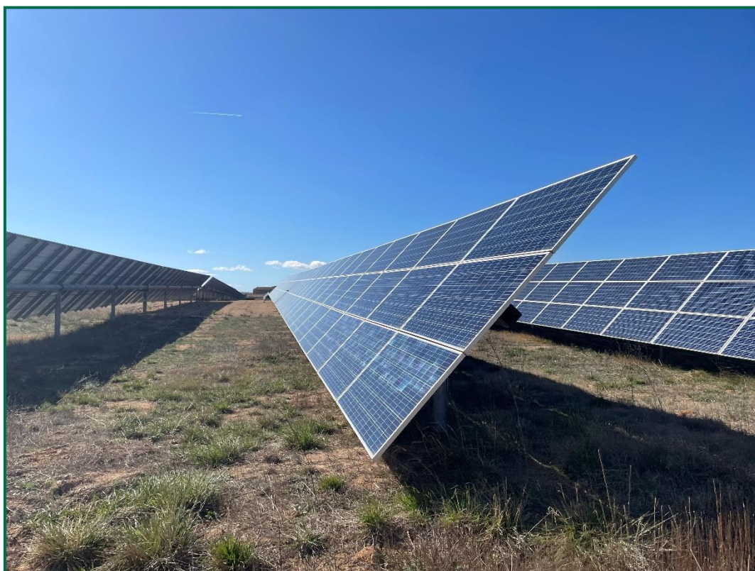
Fotografía 1. Vegetación entre placas en su estado actual.
