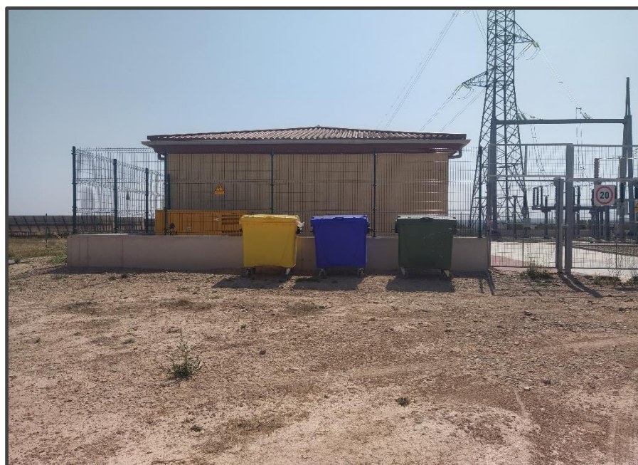
Fotografía 15. Contenedores de residuos junto a la subestación.
