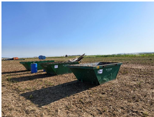
Figura 8: Contenedores para el deposito de materiales.
