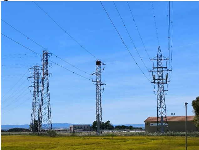
Figura 9: Nidificación sobre torre de Cigüeñas. La Torre se ubica próxima a la Subestación que todavía no se ha trabajado en ella.
