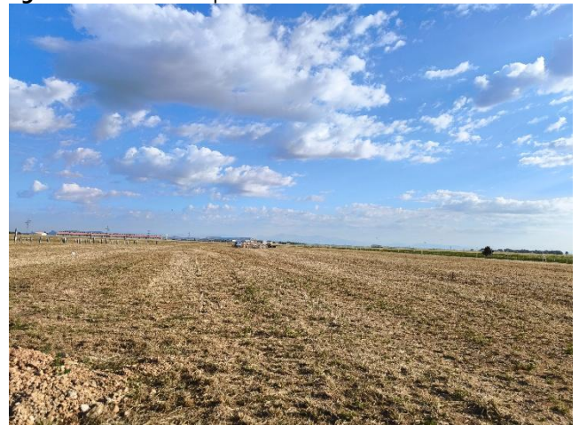
Figura 10: Superficie del PFV desbrozada y preparada para la colocación de las estructuras.
