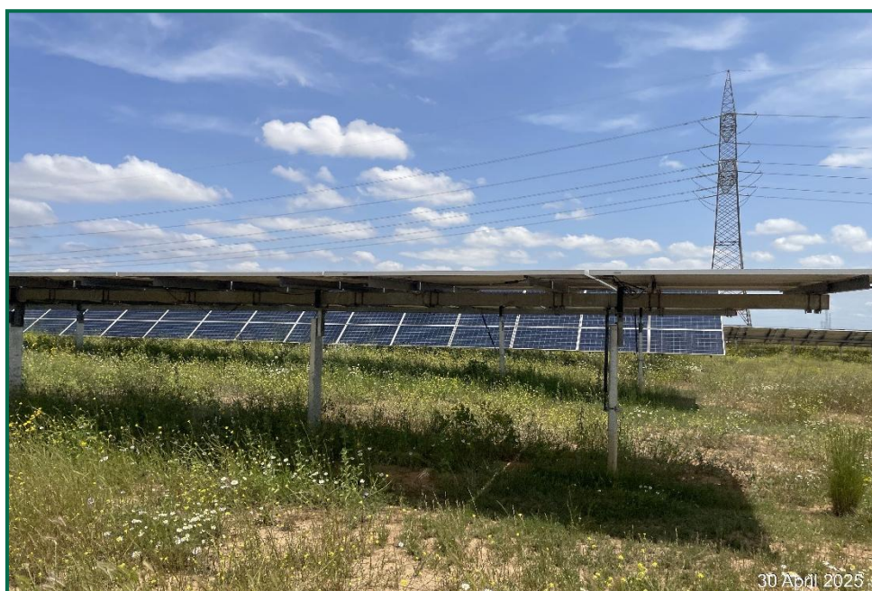
Fotografía 1. Vegetación entre placas actualmente.
