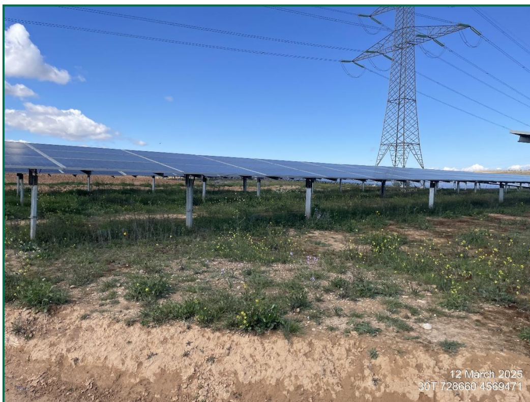
Fotografía 2. Vegetación entre placas actualmente.
