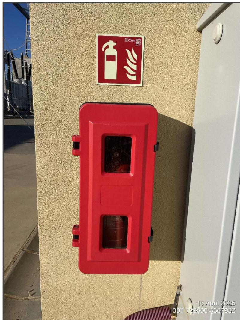
Fotografía 26. Extintores en edificio de control.
