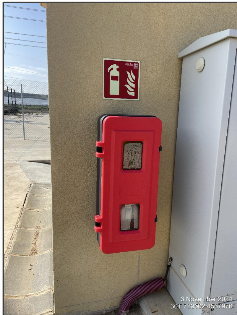
Fotografía 31. Extintores en edificio de control.
