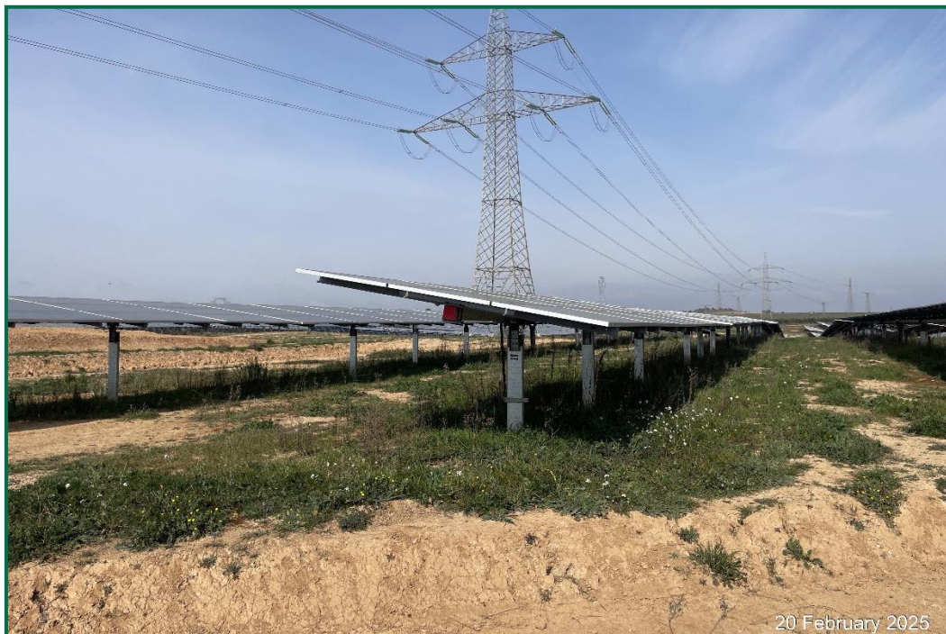
Fotografía 1. Vegetación entre placas actualmente.
