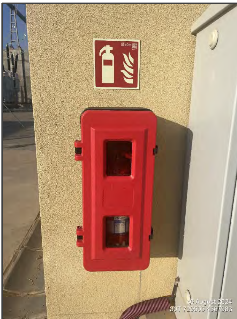
Fotografía 32. Extintores en edificio de control.
