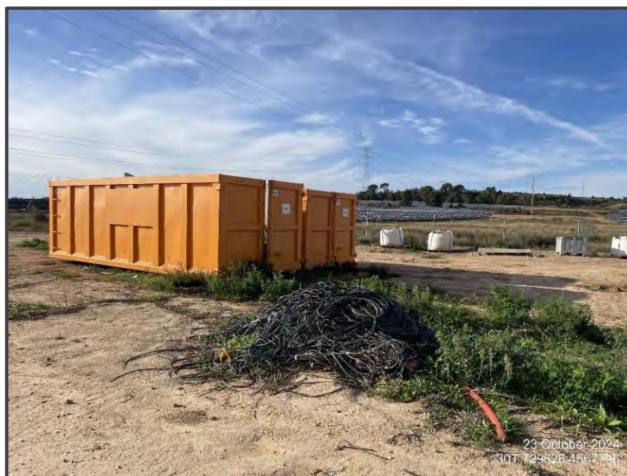
Fotografía 31. Zona de acopio de placas solares deterioradas
