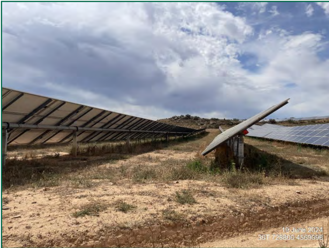
Fotografía 2. Vegetación entre placas actualmente.
