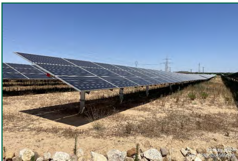
Fotografía 1. Vegetación entre placas actualmente.
