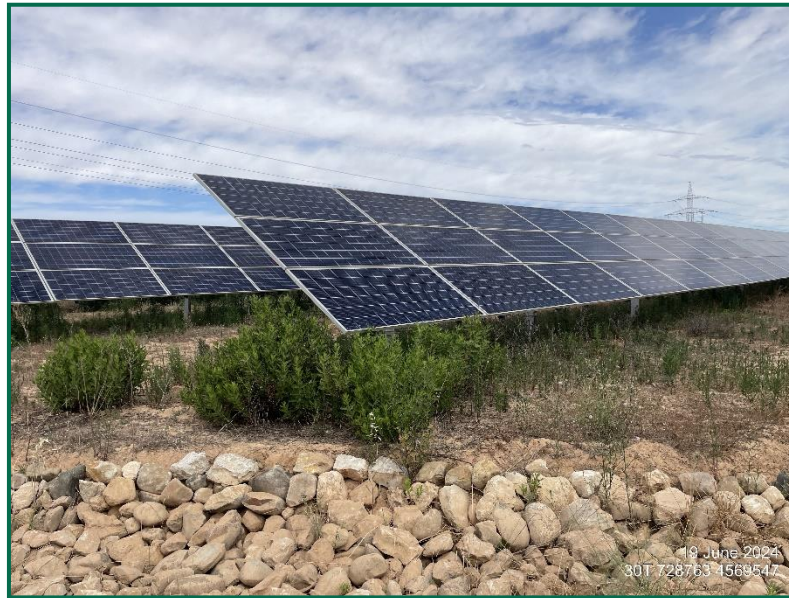
Fotografía 2. Vegetación entre placas actualmente.
