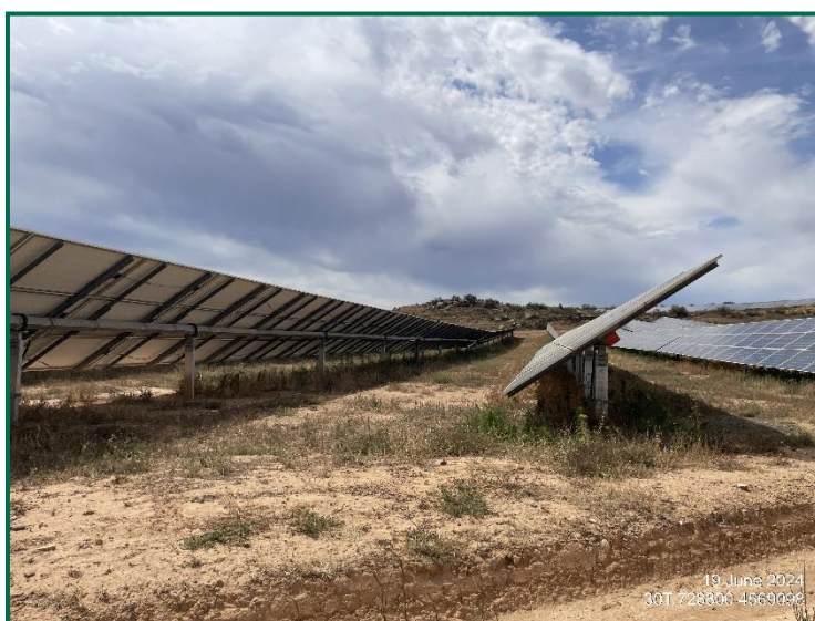
Fotografía 1. Vegetación entre placas actualmente.
