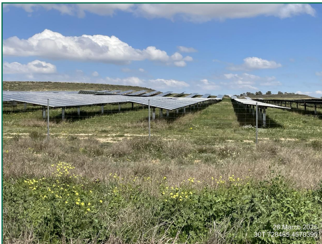
Fotografía 2. Vegetación entre placas actualmente.
