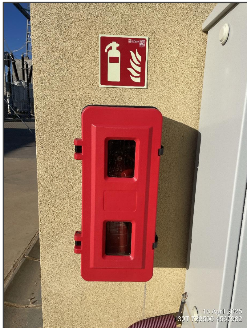
Fotografía 25. Extintores en edificio de control.
