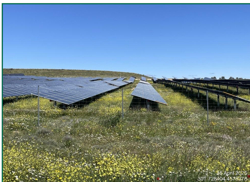
Fotografía 1. Vegetación entre placas actualmente.
