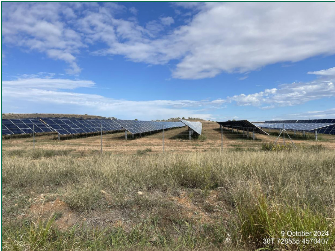
Fotografía 2. Vegetación entre placas actualmente.
