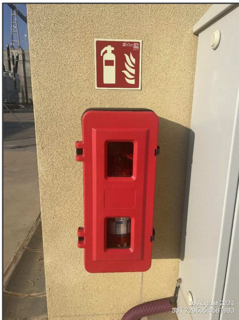
Fotografía 32. Extintores en edificio de control.
