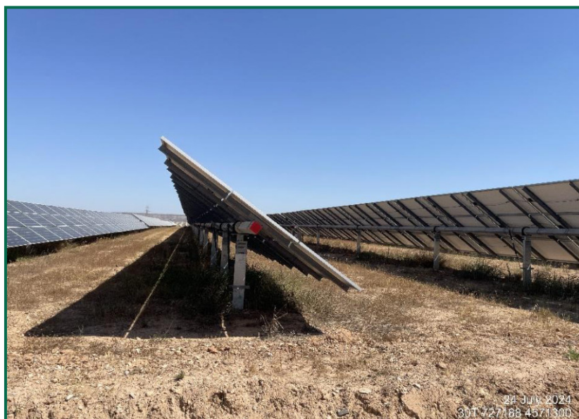
Fotografía 1. Vegetación entre placas actualmente.
