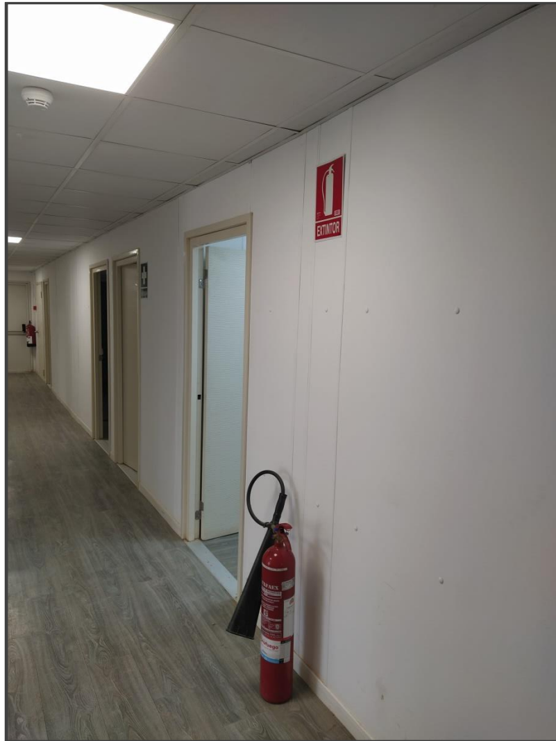
Fotografía 31. Extintores en edificio de control.
