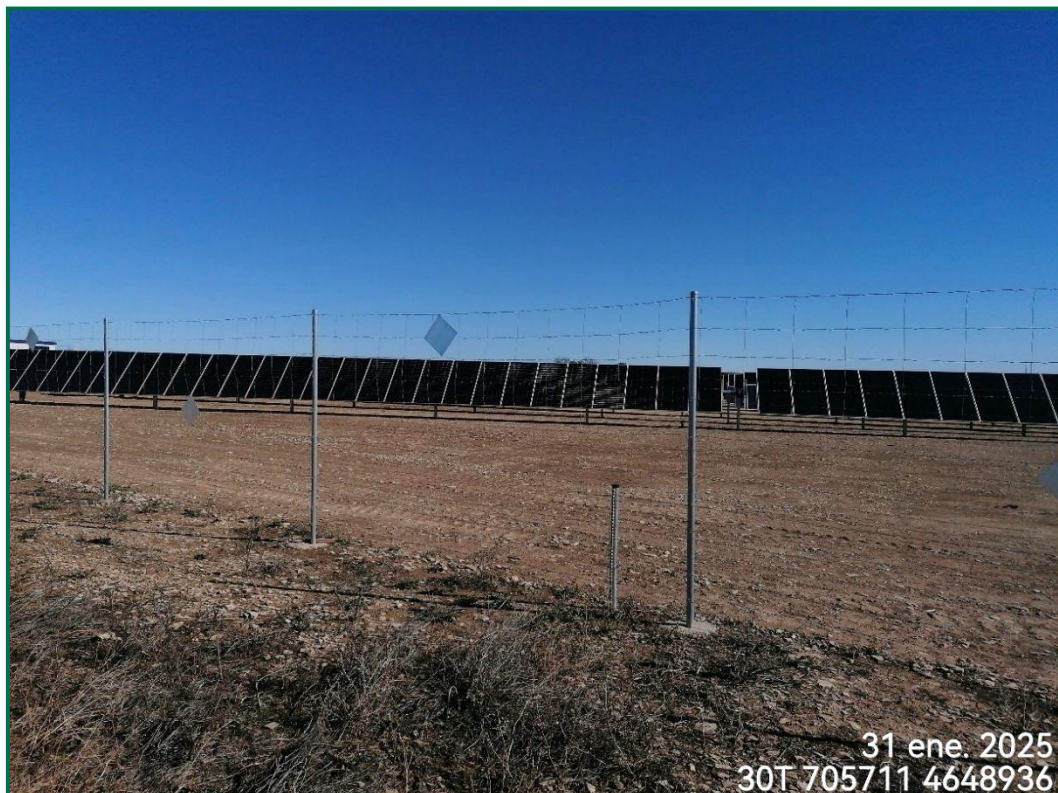
Fotografía 17. Vallado perimetral con paso de fauna y placas anticollisión.
