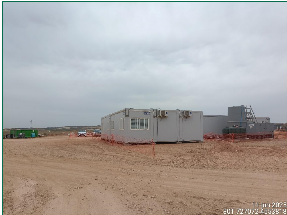
Fotografía 8. Oficinas, grupo electrógeno y bidones de combustible.
