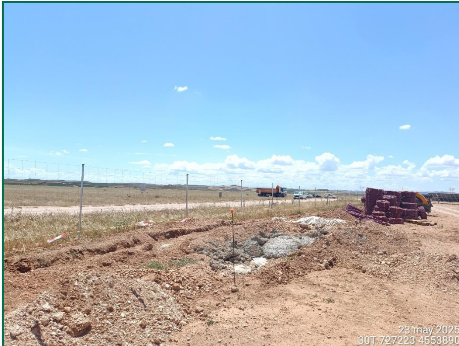
Fotografía 13. Balsa para lavado de canaletas.
