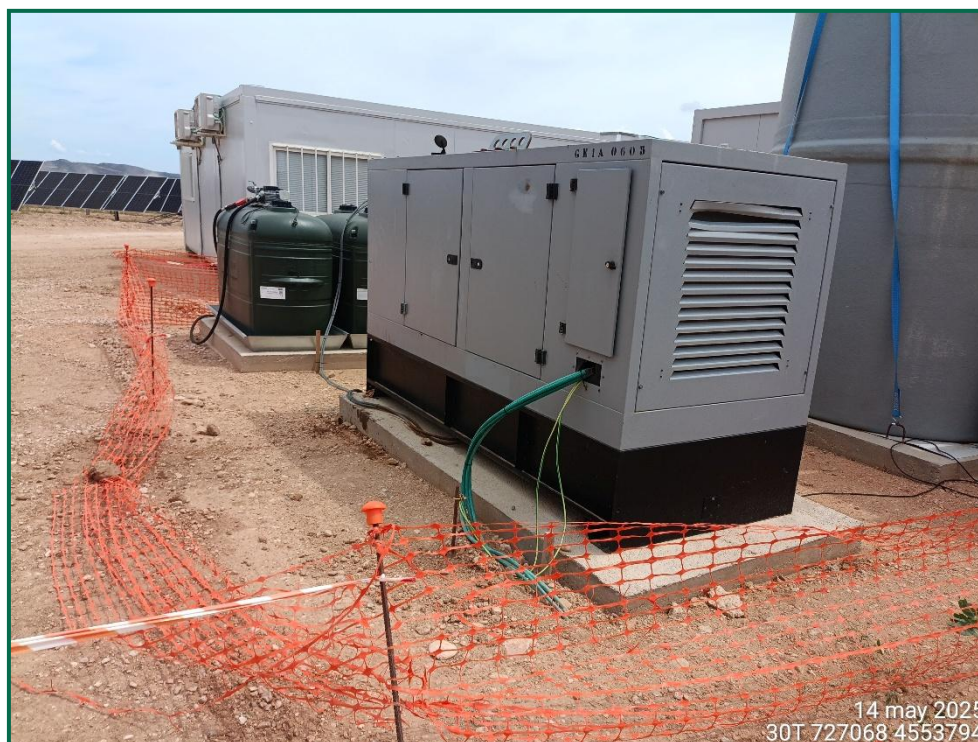
Fotografía 9. Grupo electrógeno bidones de combustible.
