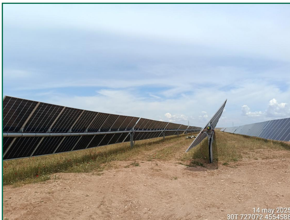
Fotografía 6. Superficie de la PFV.
