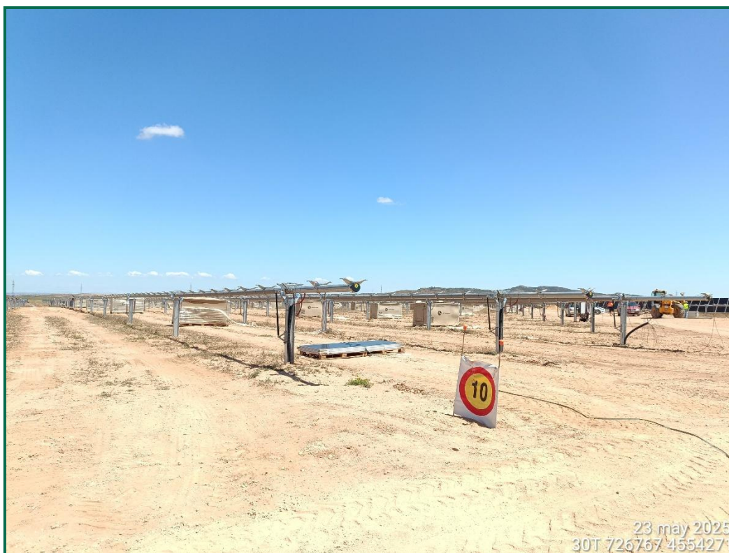
Fotografía 3. Señal de limitación de velocidad.
