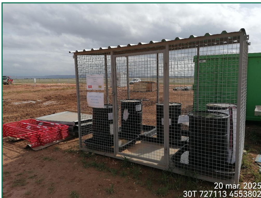
Fotografía 17. Punto limpio para residuos peligrosos.
