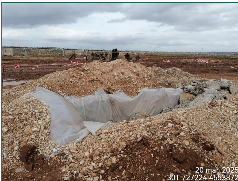
Fotografía 18. Balsa para lavado de canaletas.
