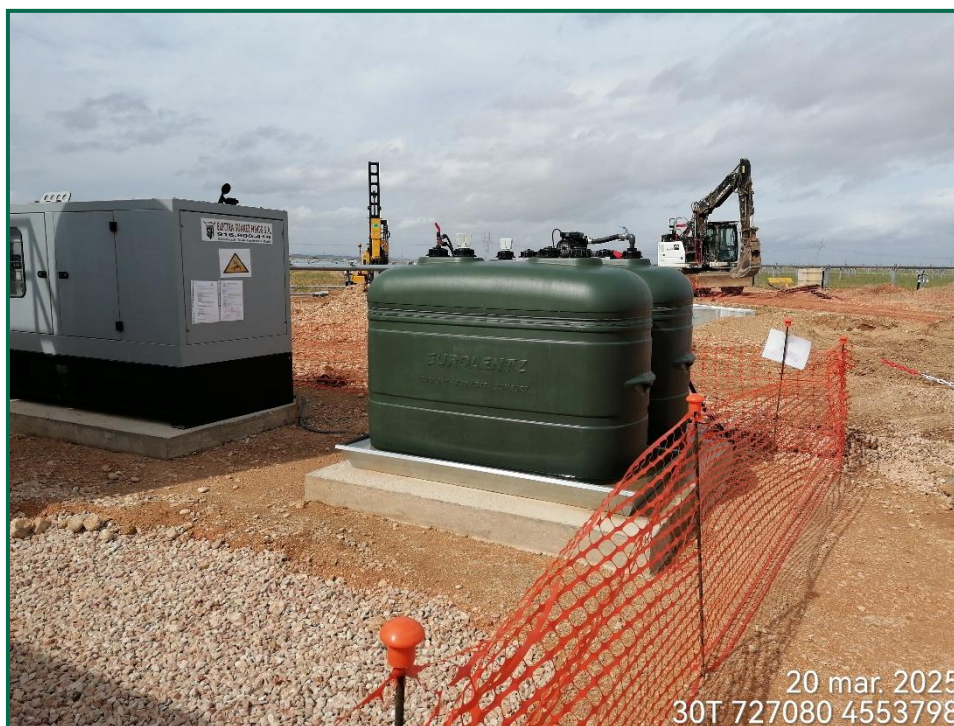
Fotografía 12. Grupo electrógeno bidones de combustible.
