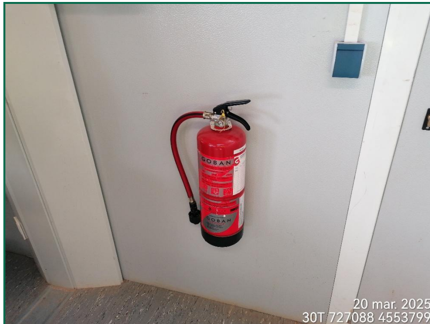
Fotografía 20. Extintor dentro de casetas de obra.
