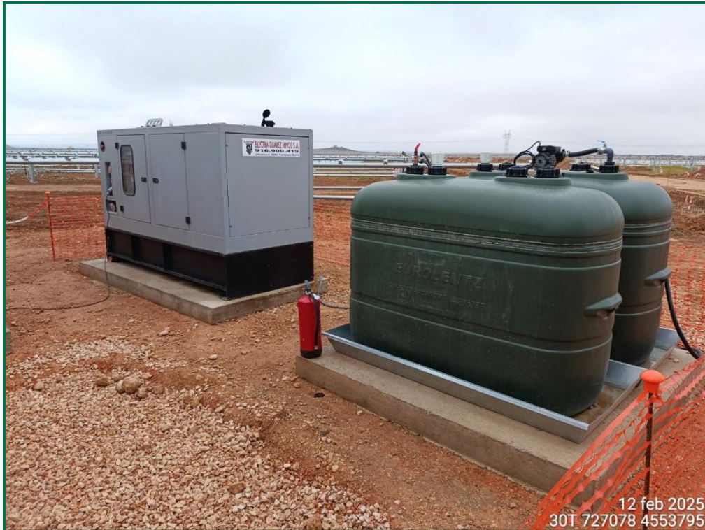
Fotografía 18. Extintor junto a bidones de combustible.
