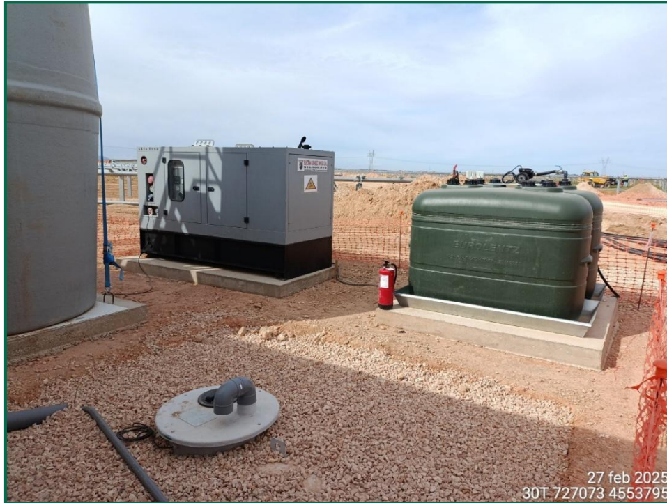
Fotografía 12. Grupo electrógeno bidones de combustible y fosa séptica.
