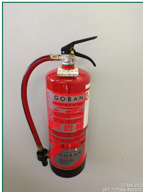
Fotografía 19. Extintor dentro de casetas de obra.
