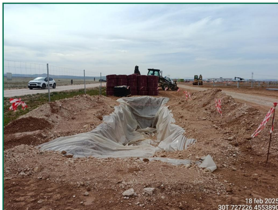
Fotografía 17. Balsa para lavado de canaletas.
