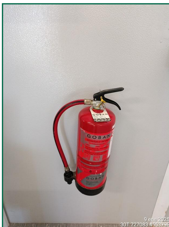
Fotografía 17. Extintor dentro de casetas de obra.
