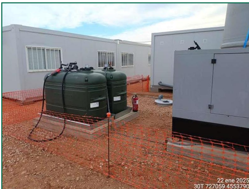
Fotografía 16. Extintor junto a bidones de combustible.
