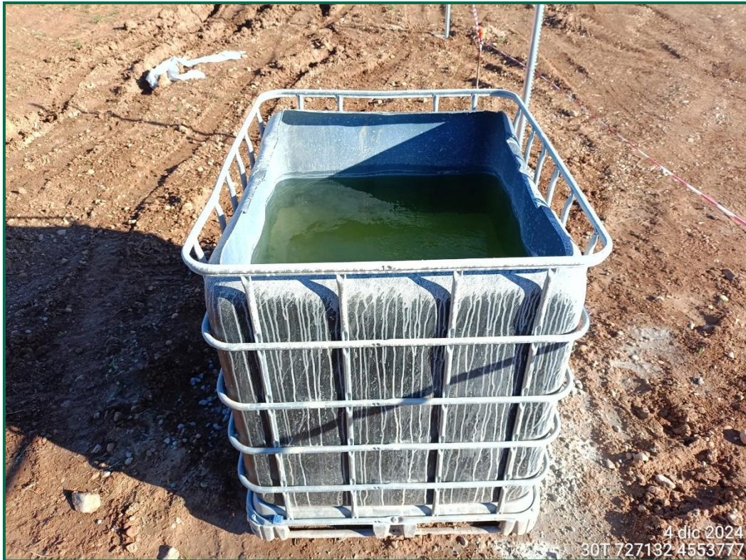
Fotografía 15. Contenedor para lavado de canaletas.
