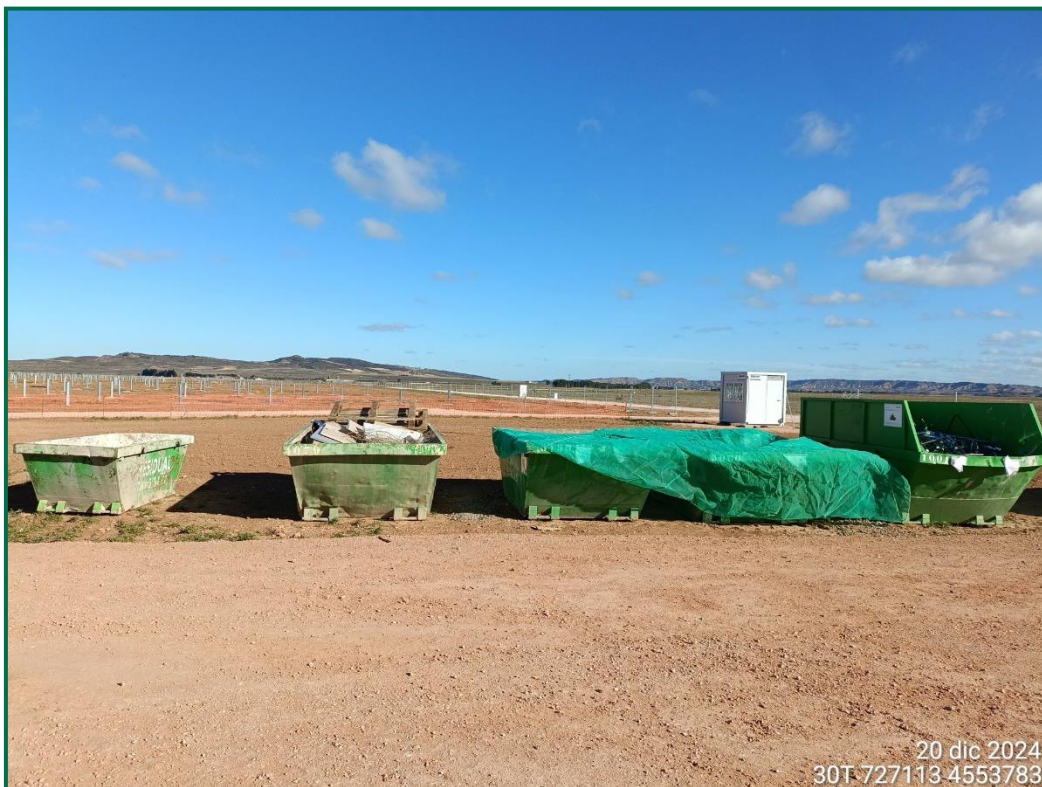
Fotografía 11. Punto limpio de residuos inertes.
