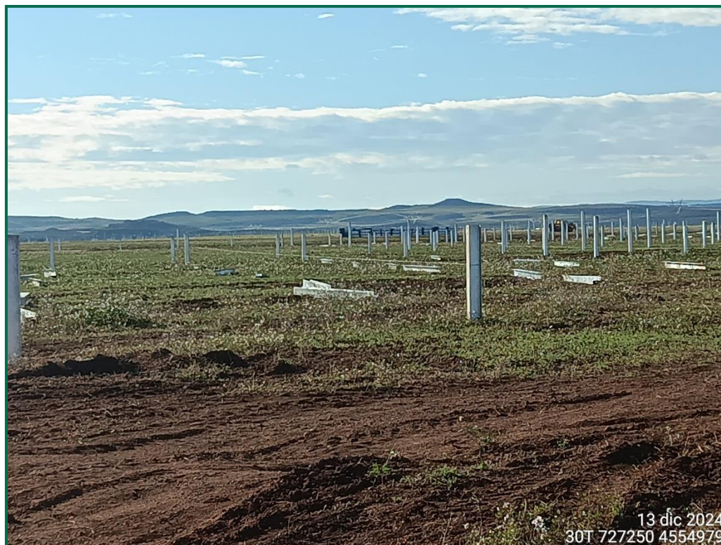
Fotografía 5. Superficie de la pfv.
