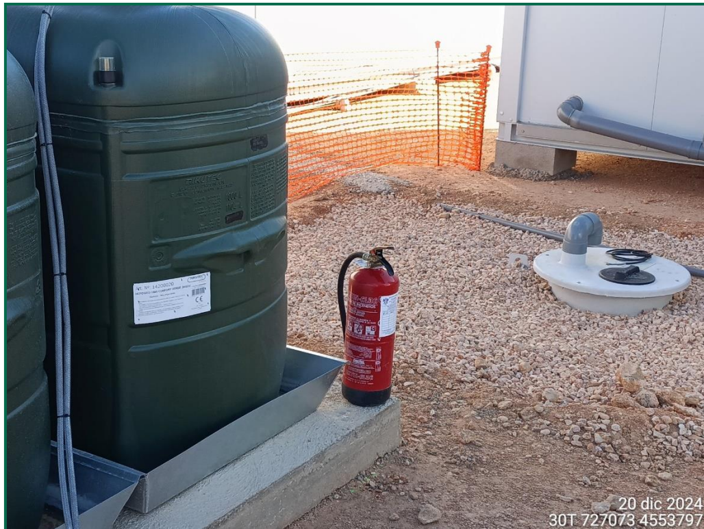
Fotografía 10. Bidones de combustible y fosa séptica.
