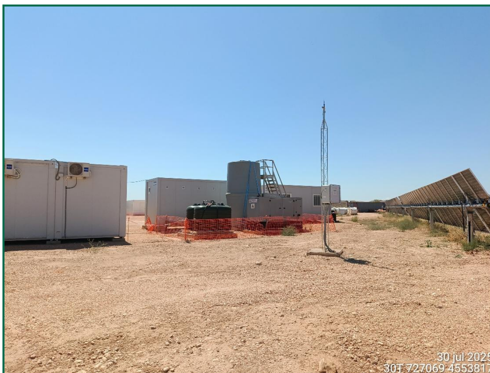
Fotografía 8. Oficinas, grupo electrógeno y bidones de combustible.
