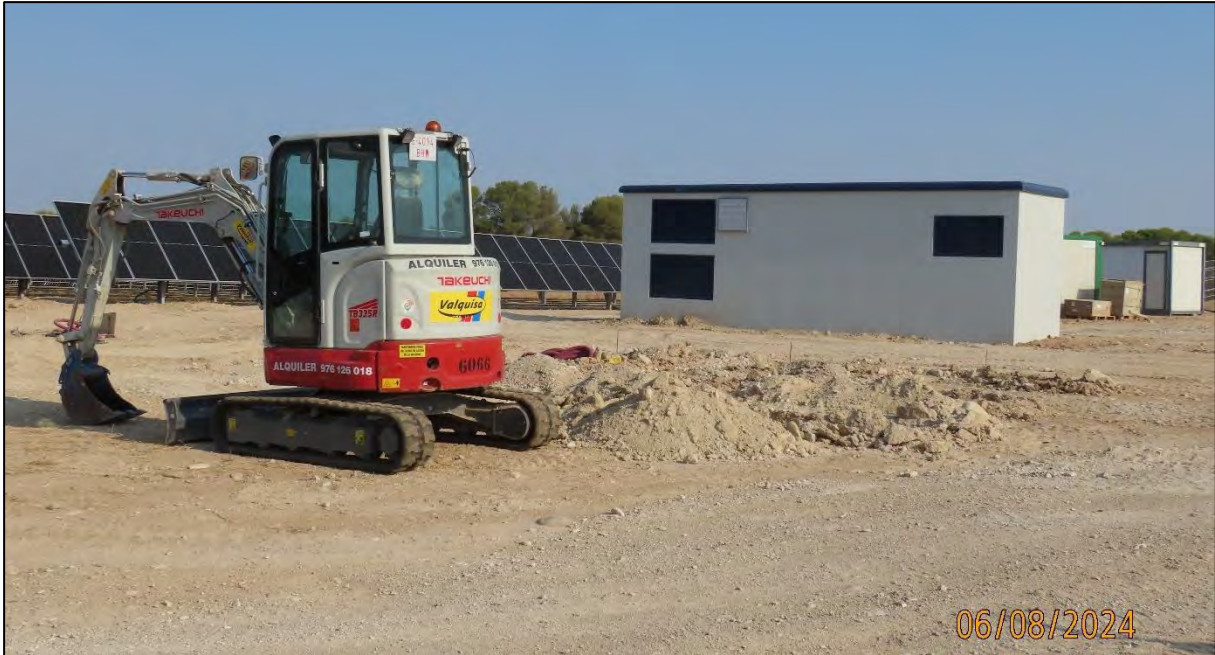
Ilustración 31. Centro de transformación preparado y a la espera de la ejecución de la LSMT.
