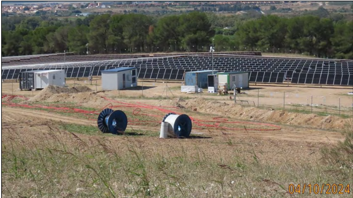
Ilustración 38. Cables de la LSMT en su punto de conexión al Centro de Seccionamiento.
