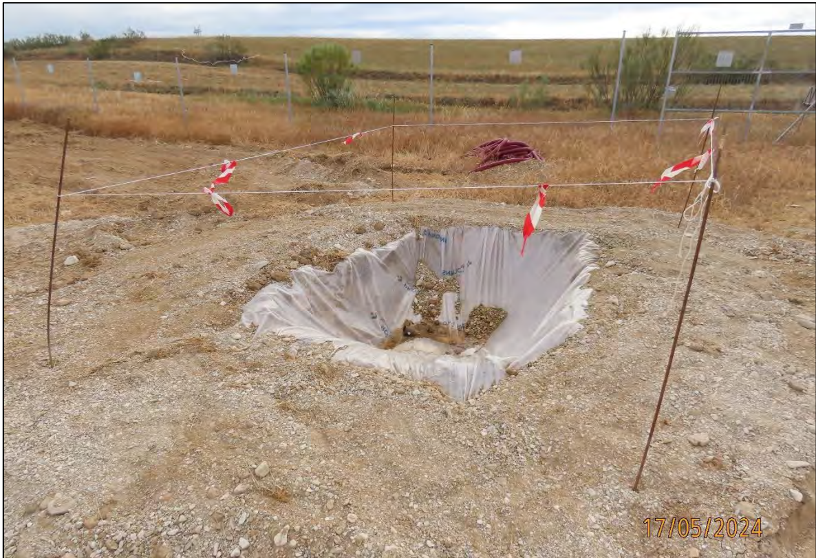
Ilustración 18. Habilitación de zona impermeable para el lavado de las cubas de hormigón.
