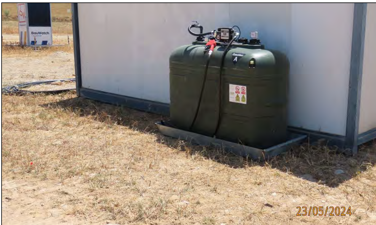
Ilustración 19. Bandeja metálica bajo depósito de combustible para evitar contaminación por vertidos.
