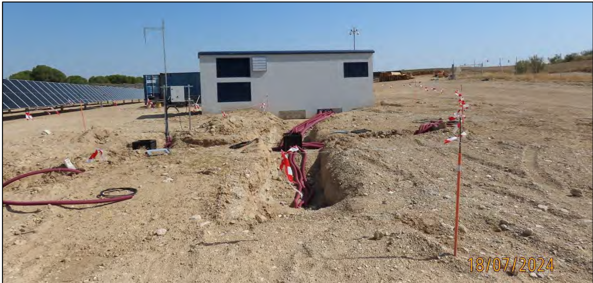
Ilustración 28. Instalación eléctrica del centro de transformación.
