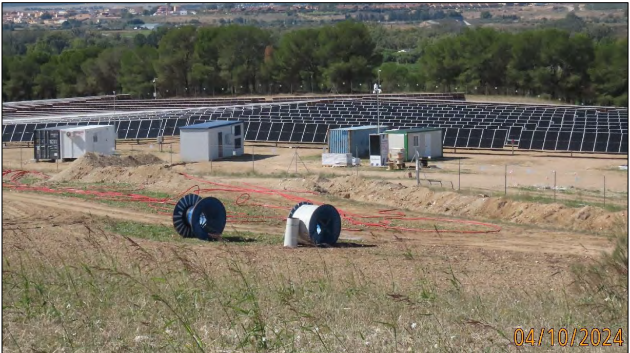
Ilustración 2. Cables de la LSMT en su punto de conexión al Centro de Seccionamiento.
