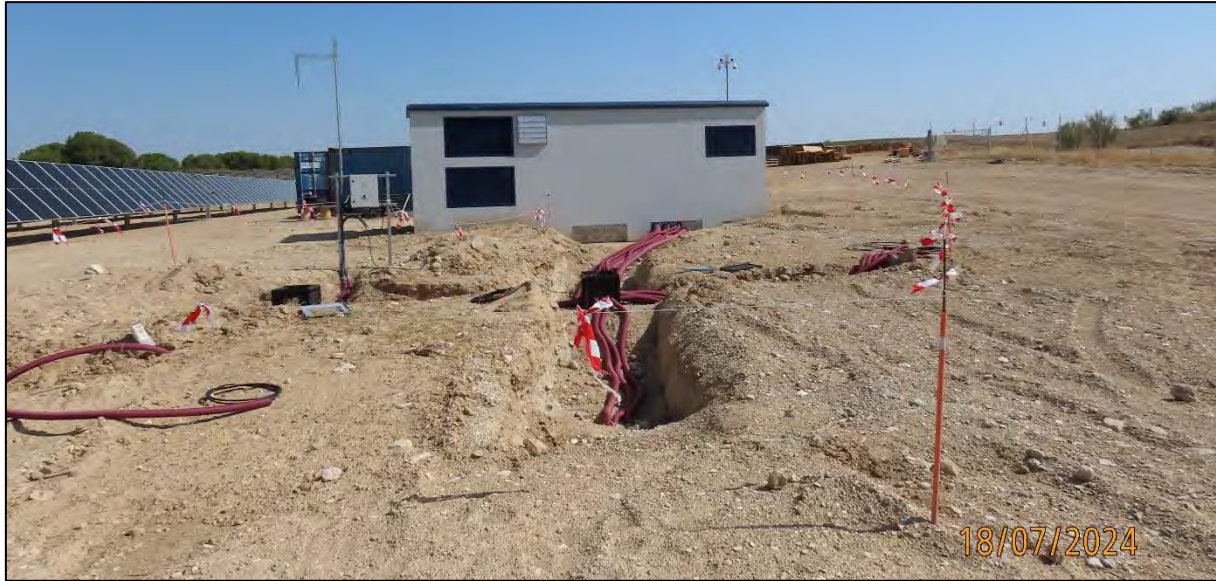
Ilustración 6. Instalación eléctrica del centro de transformación.
