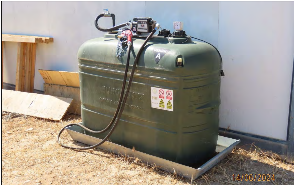
Ilustración 10. Bandeja metálica bajo depósito de combustible para evitar contaminación por vertidos.
