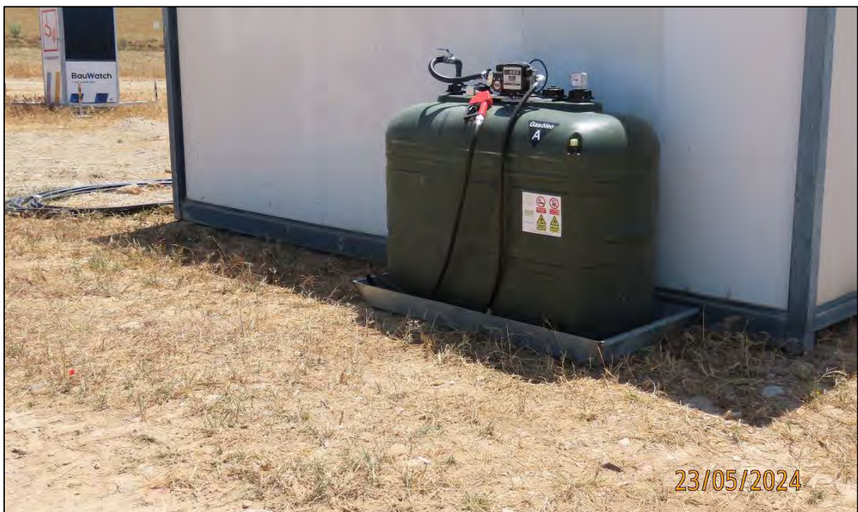
Ilustración 15. Bandeja metálica bajo depósito de combustible para evitar contaminación por vertidos.
