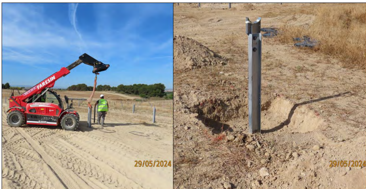
Ilustración 13. Pruebas de pull out test y apertura de hueco para cimentación en la base de las hincas.
