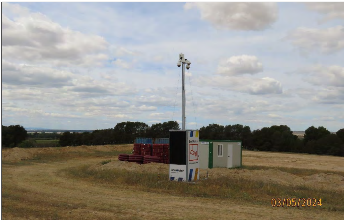
Ilustración 4. Instalación del sistema de videovigilancia.
