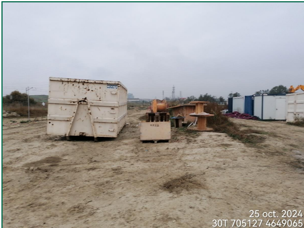
Fotografía 10. Contenedores para residuos inertes.
