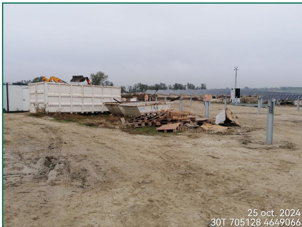
Fotografía 11. Contenedores para residuos inertes.
