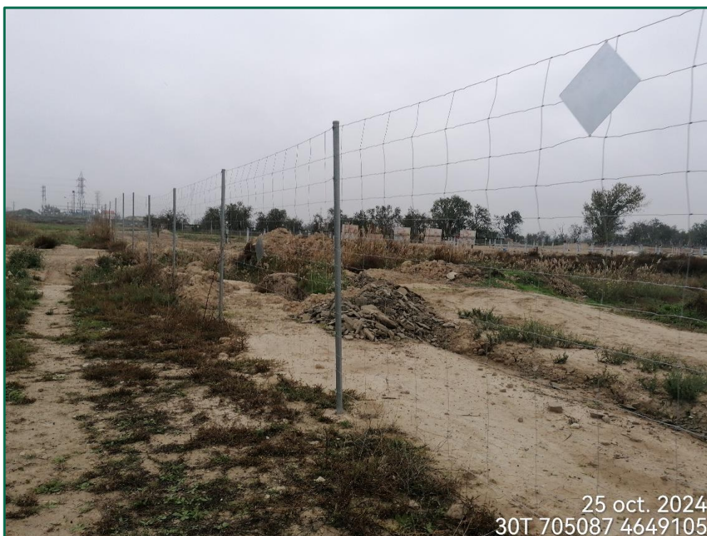
Fotografía 3. Vallado perimetral actualmente.
