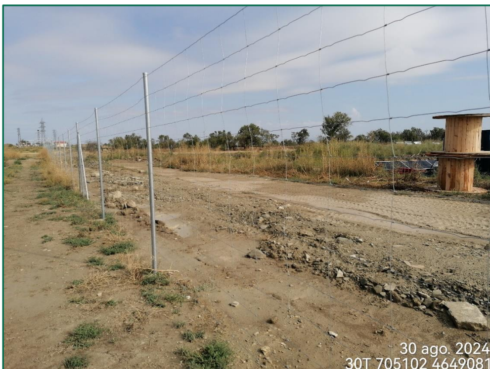
Fotografía 3. Vallado perimetral actualmente.
