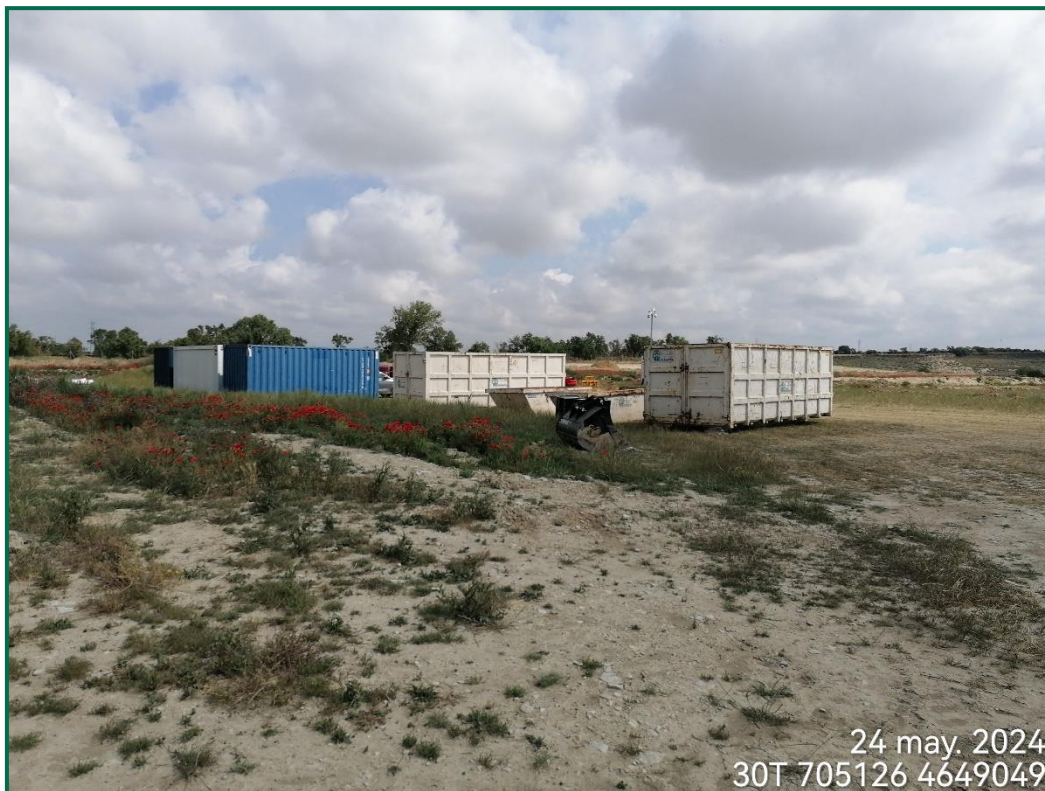
Fotografía 9. Conenedores para residuos inertes.
