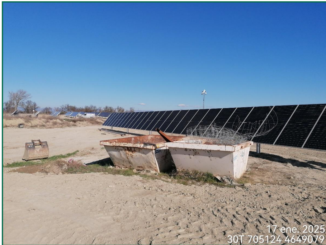
Fotografía 10. Contenedores para residuos inertes.
